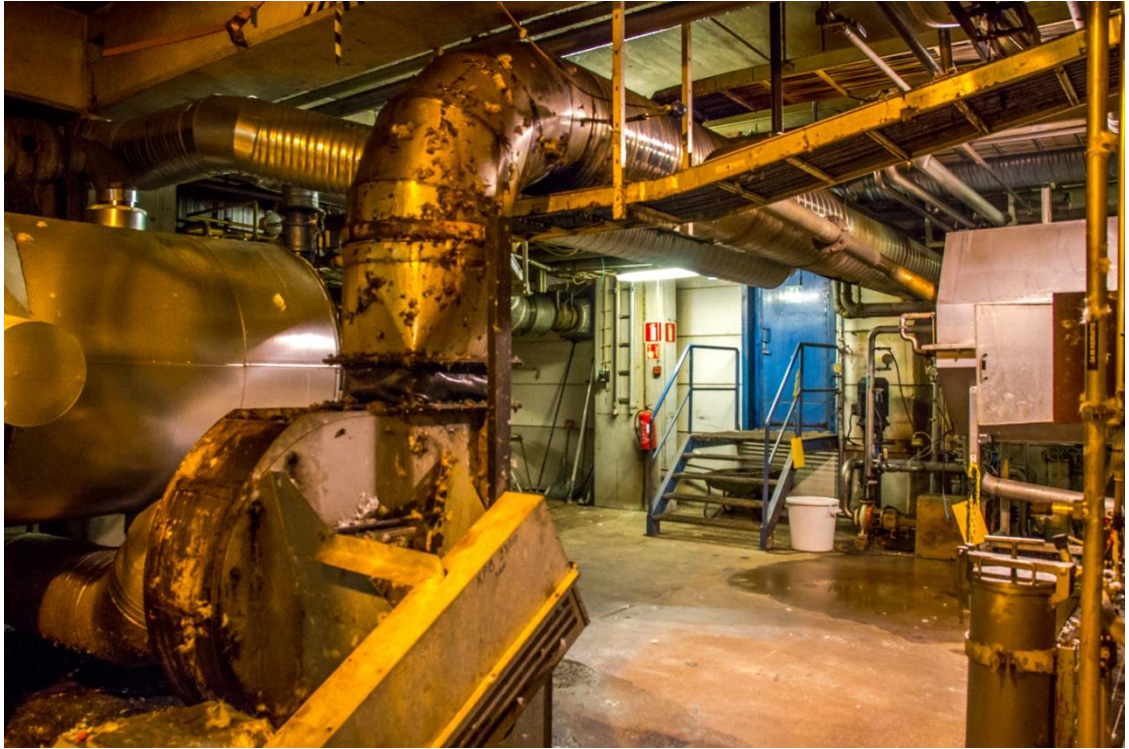
Kuva 3 Poistopuhallin 1 ja savukaasun poistoputki
