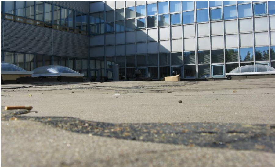
Kuva 55: Katon pinta oli hyvin muhkurainen. Kuva otettu 5.9.2014.
