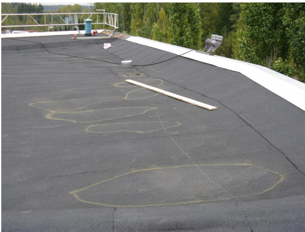
Kuva 31: Merkattuja lätköitymiskohtia katolla. Kuva otettu 26.9.2014.
