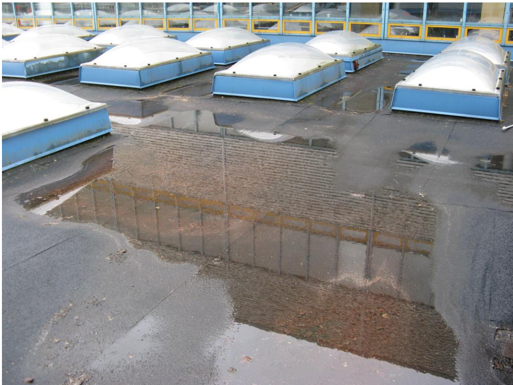
Kuva 26: Lätäköitä henkilöstöravintolan ja valmistuskeittiön vesikatolla. Kuva otettu 10.7.2014.
