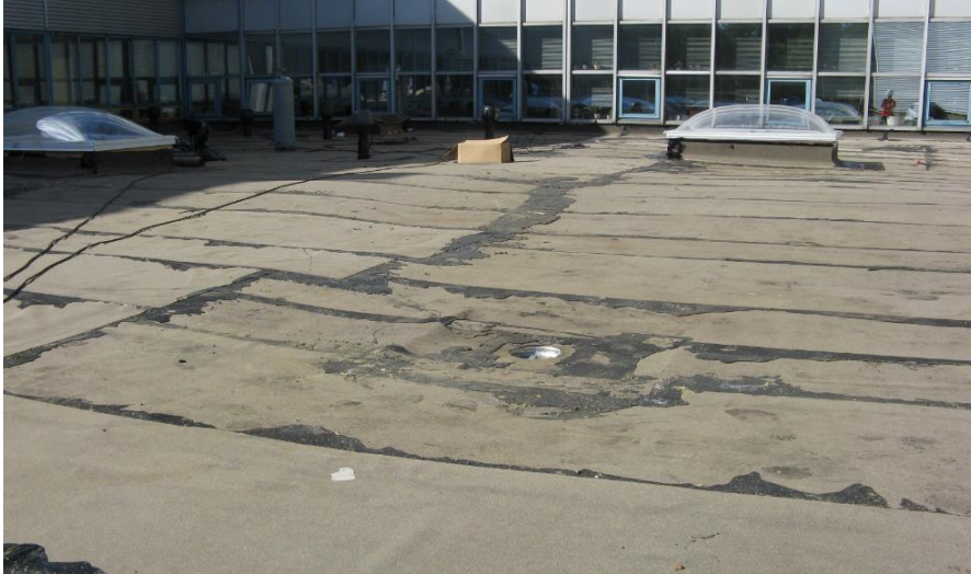
Kuva 54: Vesikaton kaatoja, joita ei voitu hyväksyä. Kuva otettu 5.9.2014.
