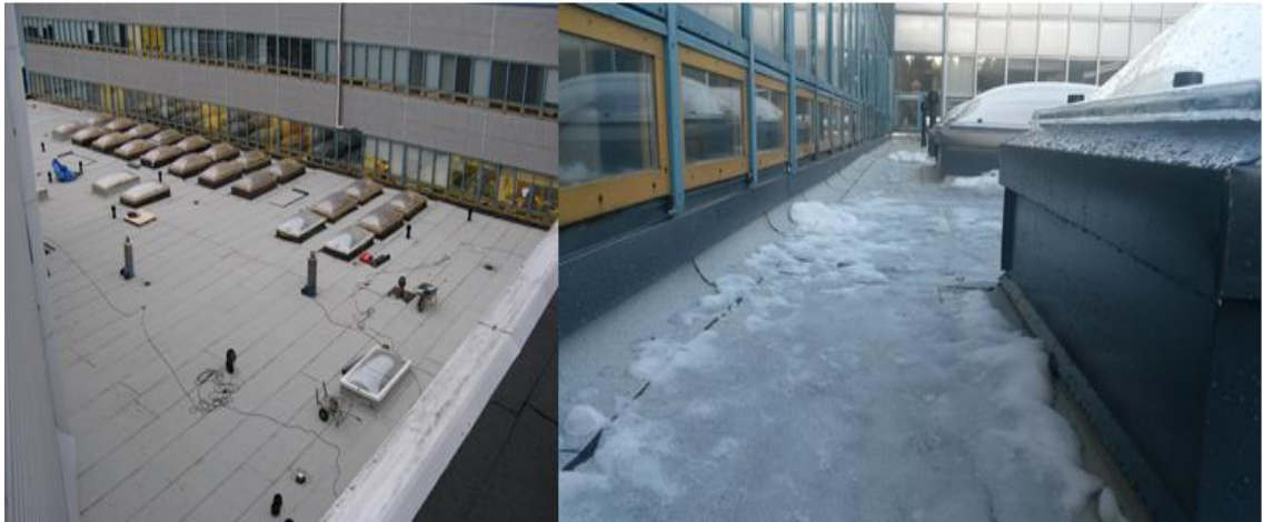
Kuva 50: Kuvia valmiista henkilöstöravintolan ja valmistuskeittiön vesikaton pintakermistä ja katolla olevista pellityksistä. Kuvat otettu 14.11.2014 ja 16.12.2014.
