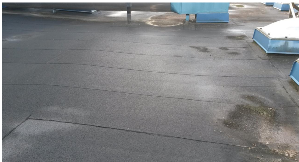
Kuva 18: Tutkittavan kohteen vesikaton pinnassa kumpareita ja painumia. Kuva otettu 10.6.2014.
