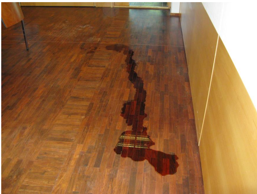
Kuva 41: Vuotanutta vettä käyttäjäpuolella. Kuva otettu 6.8.2014.
