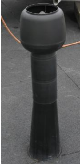
Kuva 15: Alipainetuuletin. Kuva otettu 9.10.2014.
