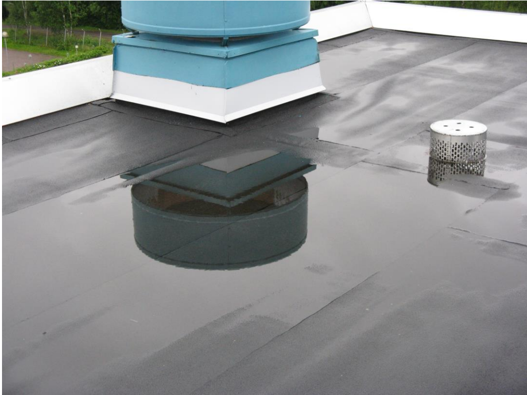
Kuva 27: Lätäkkö huutokauppasalin vesikatolla. Kuva otettu 23.7.2014.
