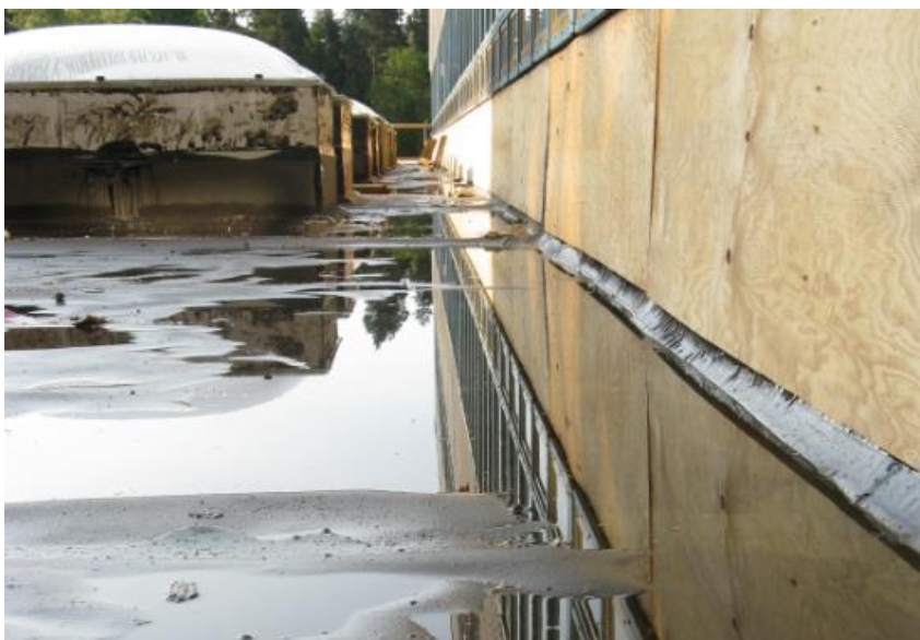
Kuva 42: Vettä kerääntynyt höyrynsulun päälle. Kuva otettu 8.8.2014.
