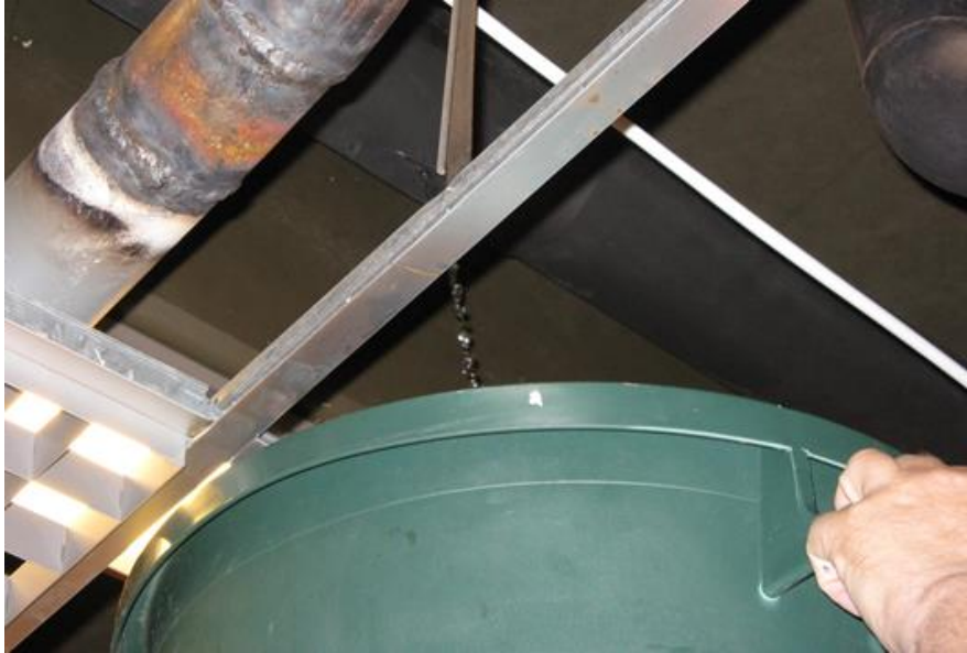
Kuva 53: Veden poistaminen eristeen sisältä. Kuva otettu 11.9.2014.
