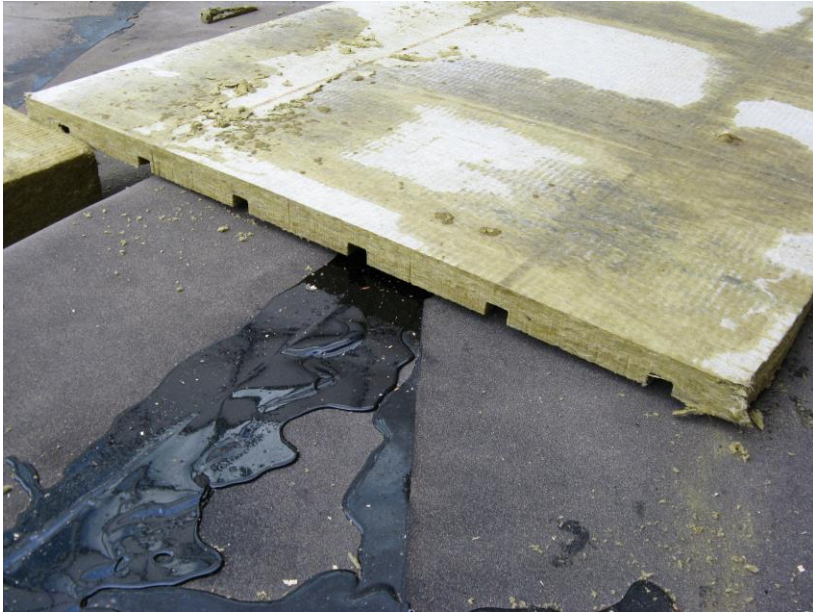
Kuva 47: Uritettu lämmöneriste. Kuva otettu 15.8.2014.
