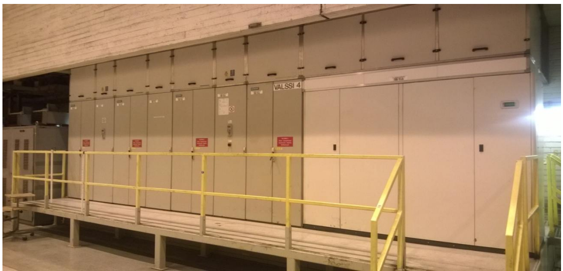
Kuva 26. Valssituoli 4 päämoottorin tasavirtakäytön kaapit
