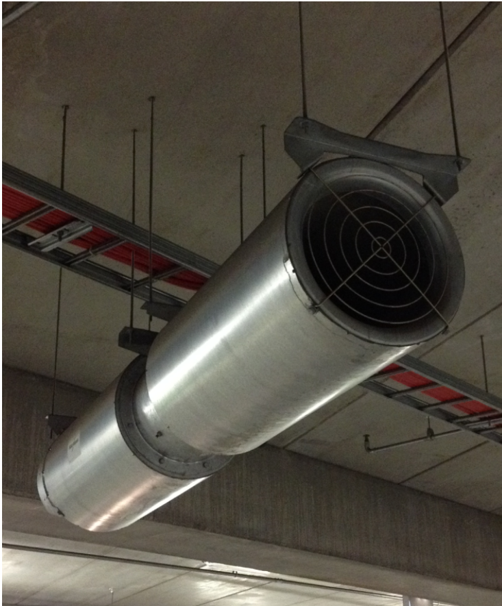
KUVA 9. Suojaritulällä varustettu suuntapainepuhallin imupuolelta kuvattuna
