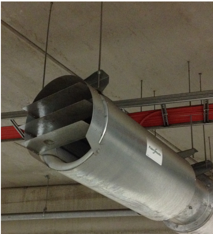
KUVA 10. Suuntapainepuhaltimen painepuoli, joka on varustettu puhalluksenohjaussivillä
