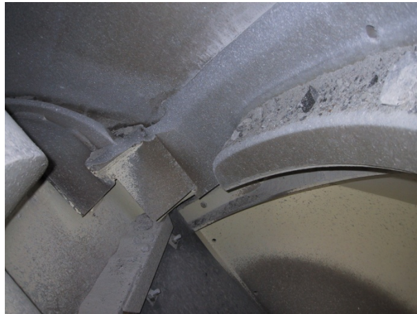
Kuva 8. Alahelmsuojan päälle kertynyt materiaalikerros suojaa alarunkoa /3/
