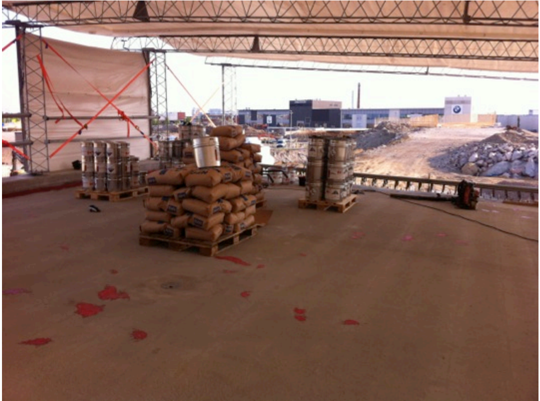
Kuva 12. Epoksitiivistystä varten tarvittava kvartsihiekkä ja epoksikomponentti A -ja B -säiliöitä. Alustan epätasaisuudet on paikattu jo valmiiksi hiekkaepoksilla.
