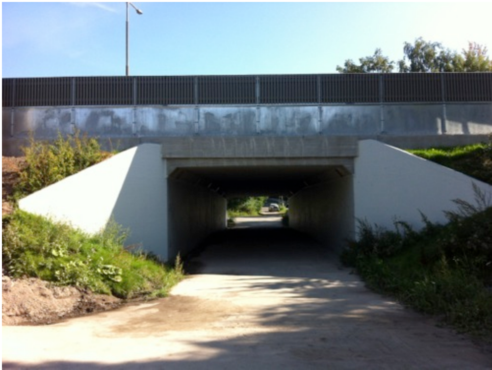
Kuva 1. Kirjokallion alikulkukäytävänä toimiva kehäsilta, johon on uusittu muun muassa reunapalkit ja vedeneriste.
