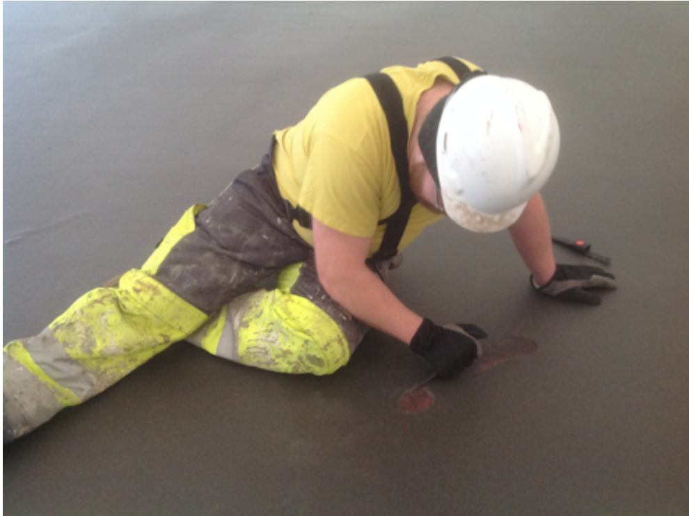
Kuva 21. Elastomeeripinnoitteen huonosta paikallisesta tartunnasta johtuvien huokoskuplien puhkaisu ja tarttumattoman pinnoitteen poisto ennen eristeen paikkausta.
