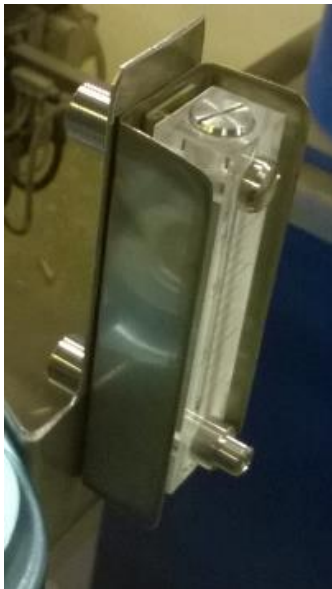
Kuva 21. Rotametrin taustakilpi asennettuna.
