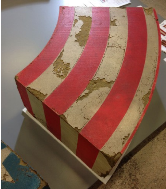
Kuva 15: Istuimen vaurioita Kuvat: Katri Kurkela 2015
