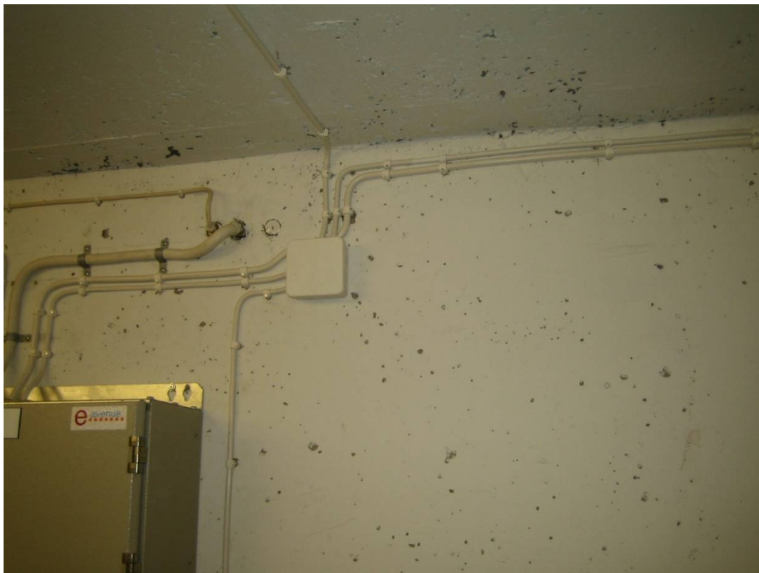
Kuva 23. Väestönsuojan seinän ja katon maalipinta on paikoitellen huonokuntoinen.
