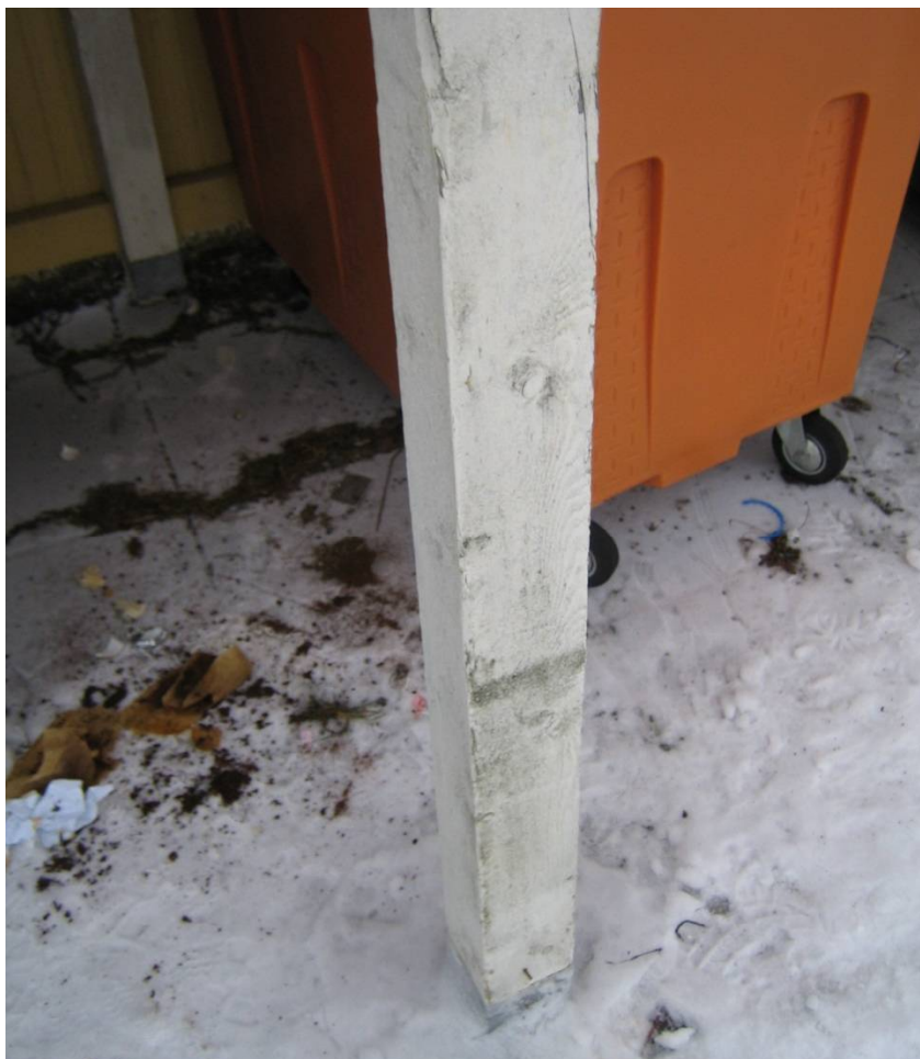
Kuva 8. Jätekatoksen pintamaalit ovat tummuneet.
