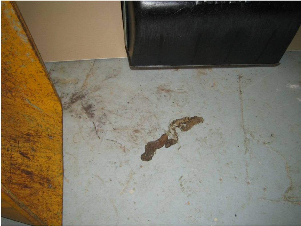
Kuva 19. Lämmönjakohuoneen lattiaan maalipinnat ovat paikoitellen huonokuntoiset.
