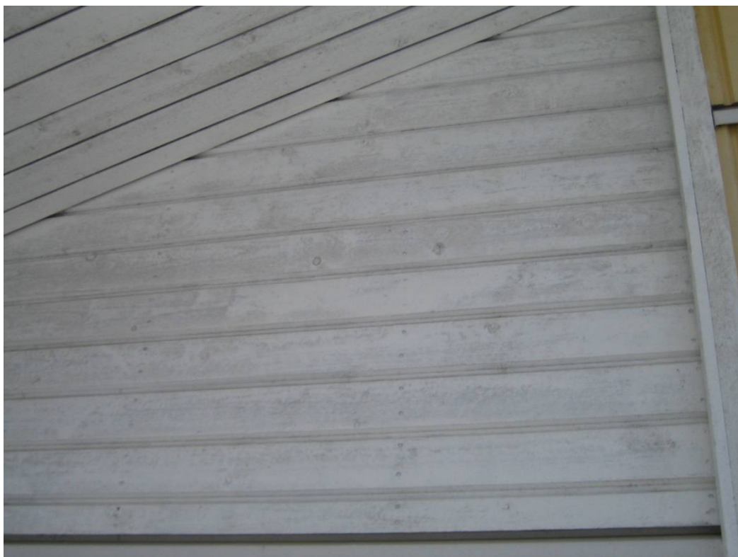
Kuva 12. Julkisivuverhouksen puuosat ovat tummuneet.
