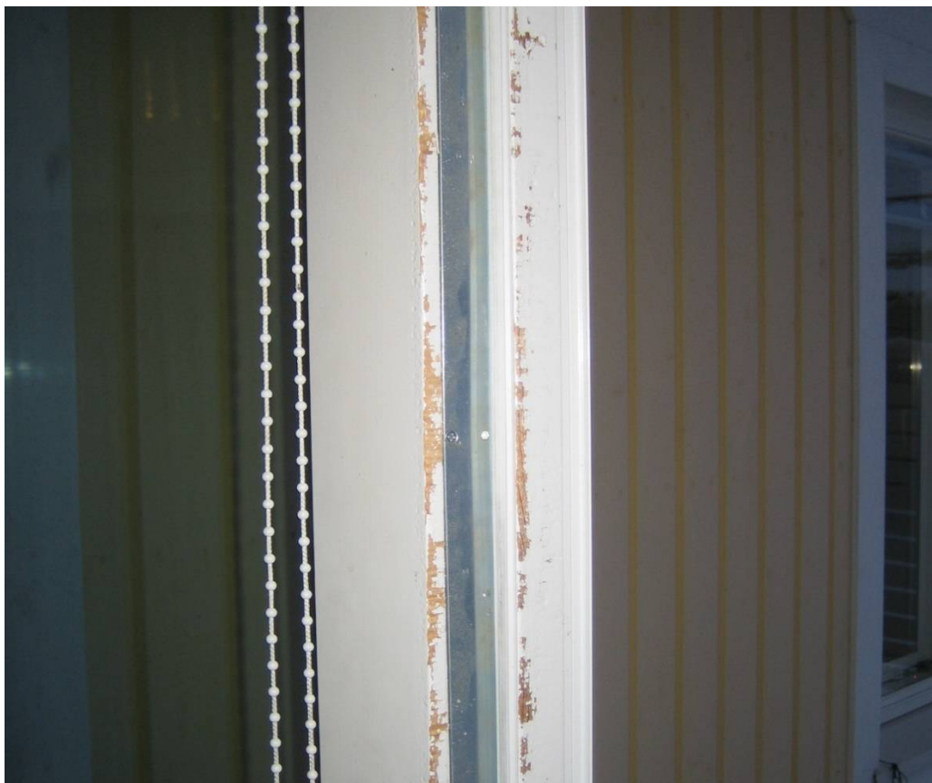
Kuva 14. Kuistin oven maali on rapistunut.
