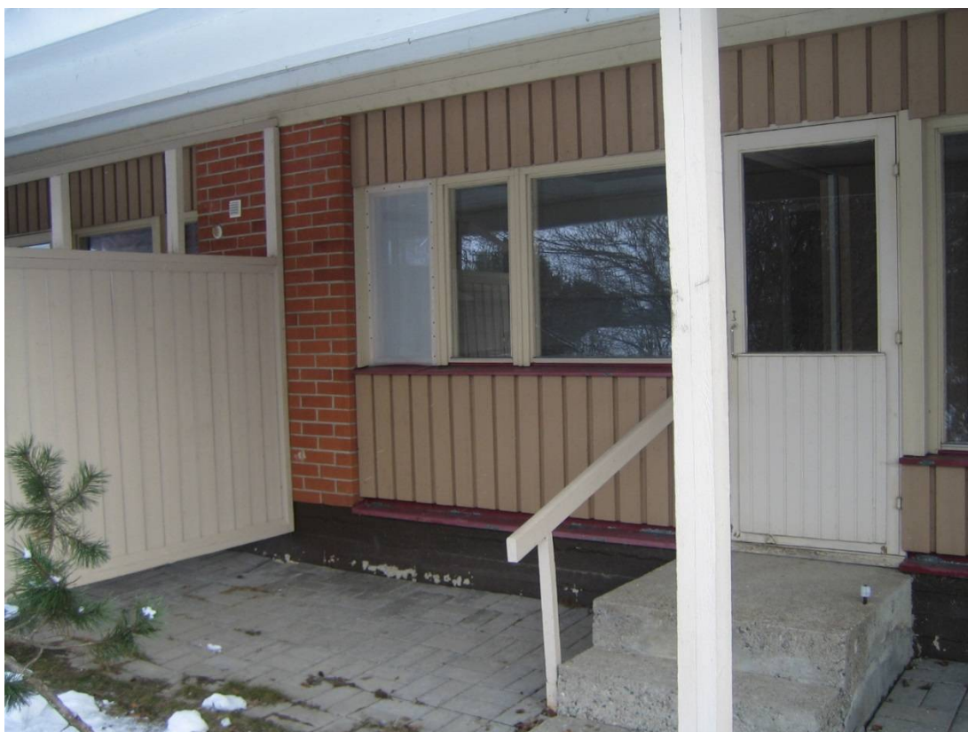
Kuva 14. Terrassien pinnat ovat pääosin hyväkuntoisia.
