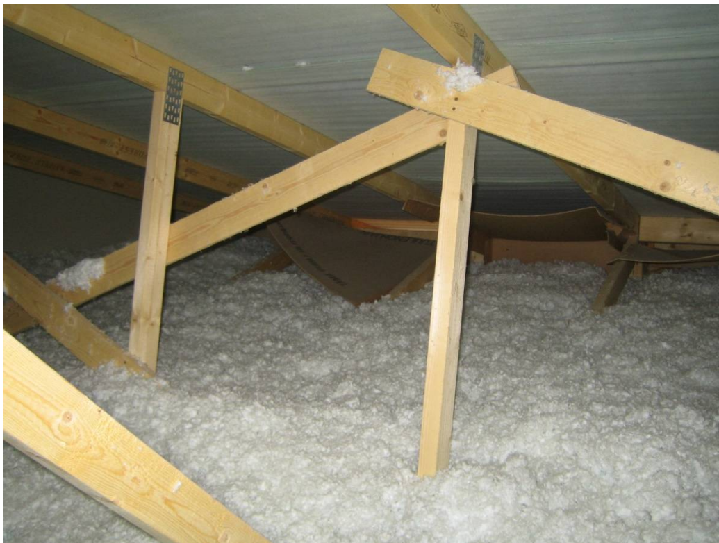
Kuva 11. Yläpohjien tuulenohjauslevyt repsottavat ja ovat osittain pois paikoiltaan.
