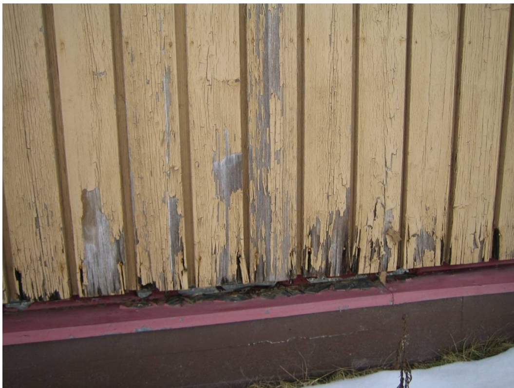
Kuva 8. Huoltorakennuksen koillisseinän laudat ovat lahonneet.
