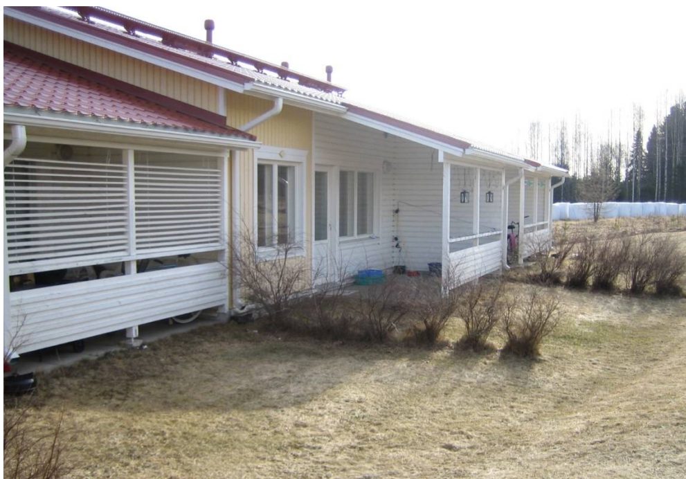
Kuva 5. Pensaat kasvavat liian lähellä rakennusta.
