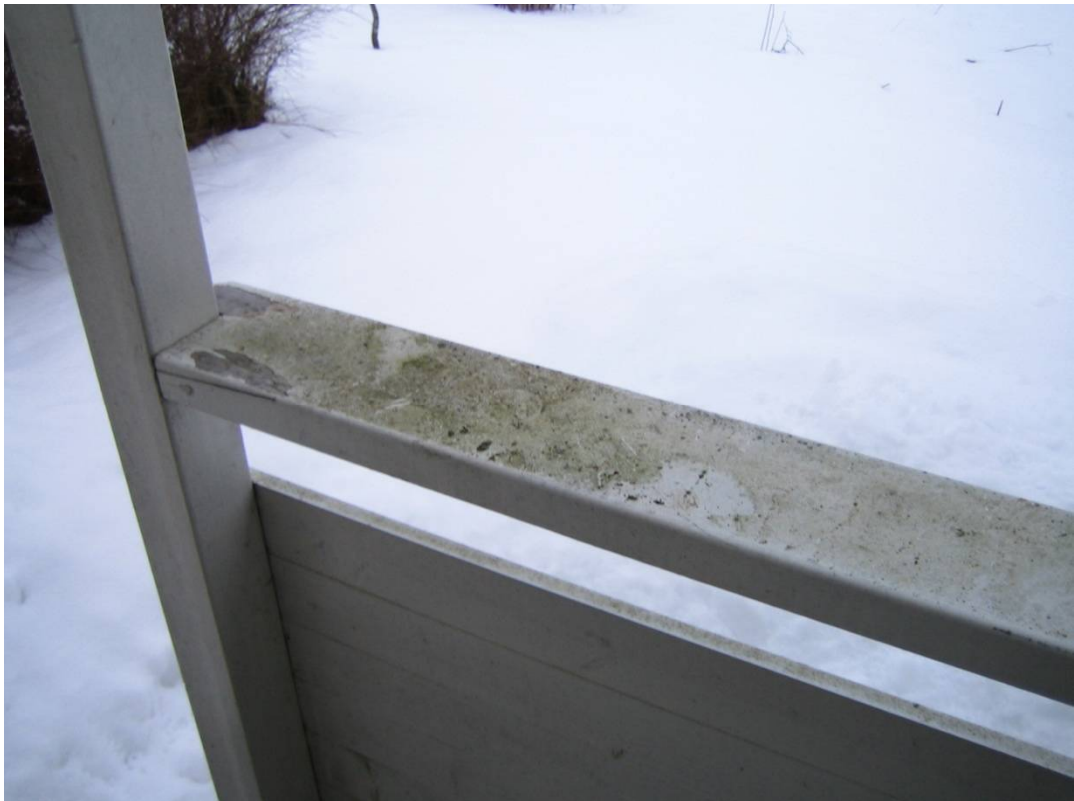
Kuva 16. Takaterassien kaidepuut ovat sammaloituneet.
