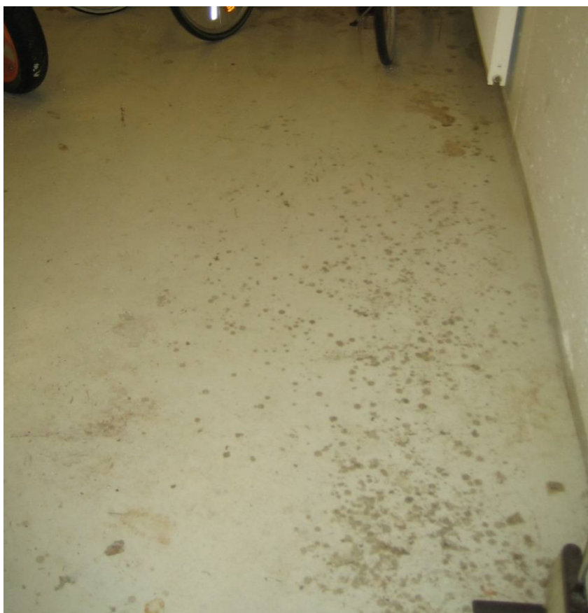
Kuva 24. Väestönsuojan lattian maalipinta on huonokuntoinen.
