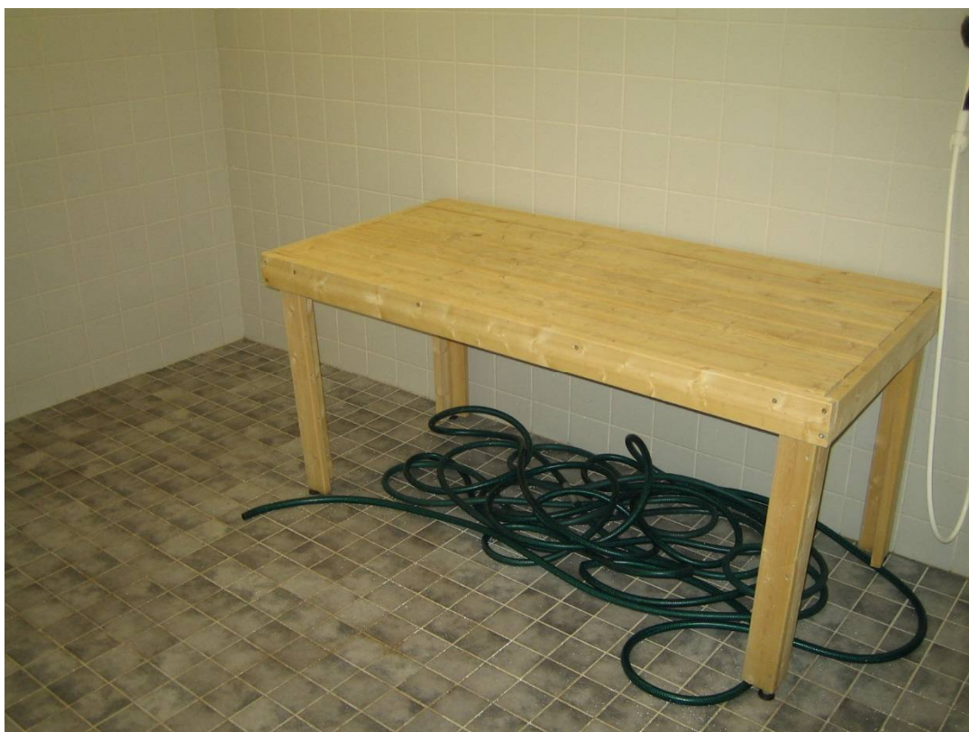
Kuva 25. Kuivaus- ja pesuhuoneen lattialaatoituksen saumaukset ovat paikoitellen tummuneet.
