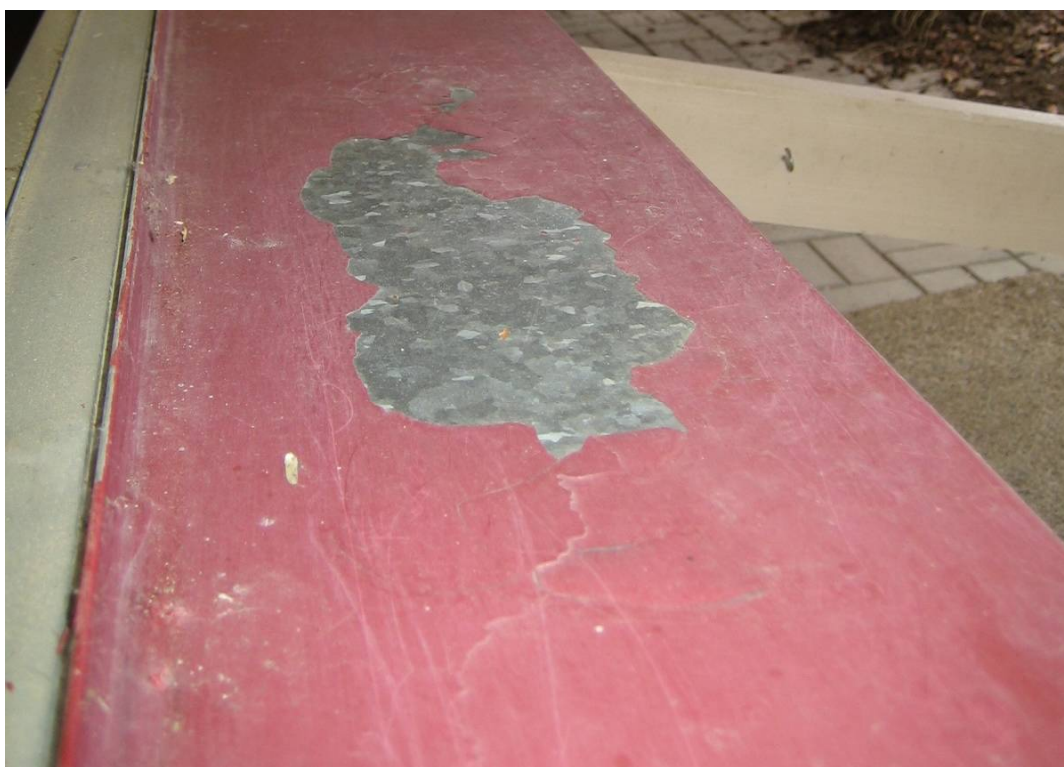
Kuva 10. Ikkunoiden vesipeltien maalipinnat ovat huonokuntoisia.
