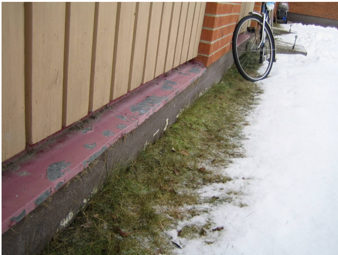
Kuva 13. Perusmuurin ja puuverhouksen välisen vesipellin maalipinta on huonokuntoinen.
