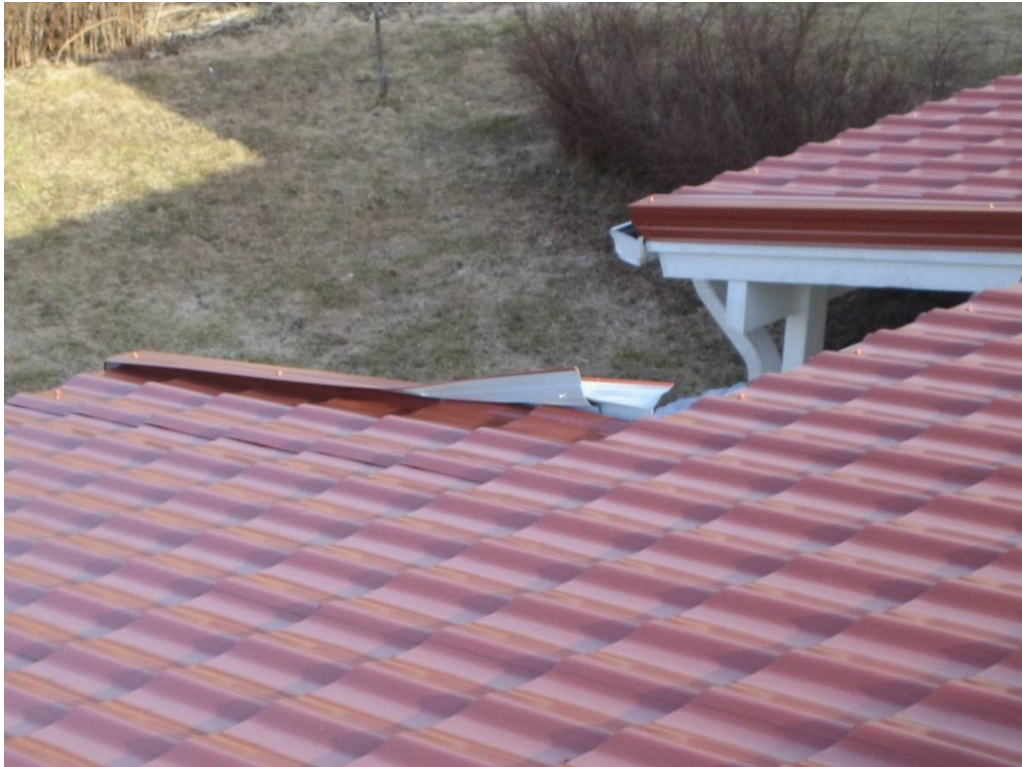
Kuva 17. Lumi on vääntänyt vesikatteen reunapellin mutkalle.
