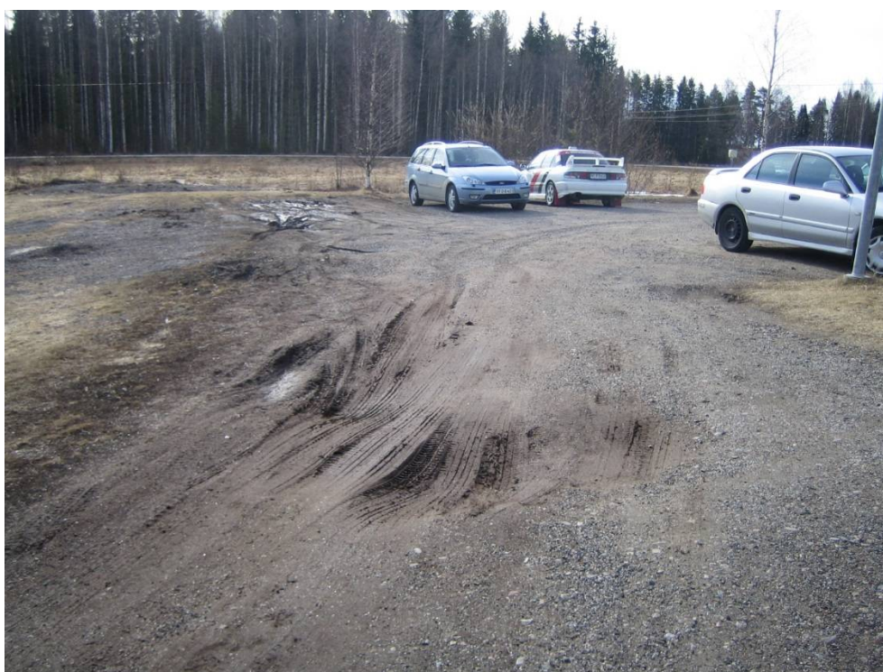
Kuva 4. B- ja C-talon välinen kulkutie on huonossa kunnossa.
