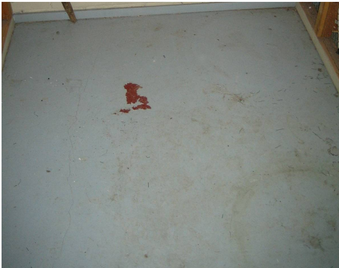
Kuva 17. Varaston lattiapinnat ovat paikoitellen huonokuntoiset.
