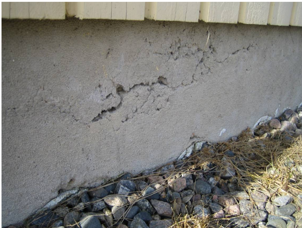
Kuva 9. A-talon perusmuurin pintavaurio.
