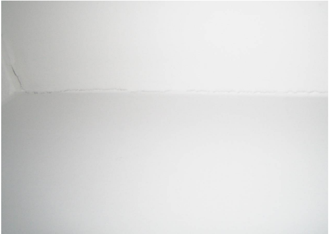
Kuva 21. Kattopinnoilla on paikoitellen halkeamia.
