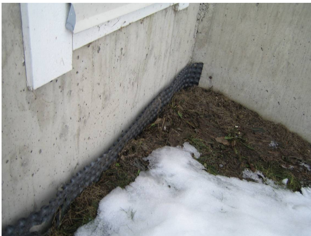
Kuva 10. B-talon koillispään patolevystä puuttuu peitelistä.
