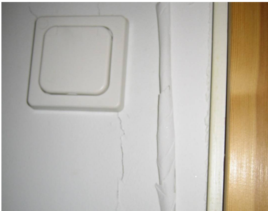
Kuva 18. Vessan seinän maalipinta on irronnut.
