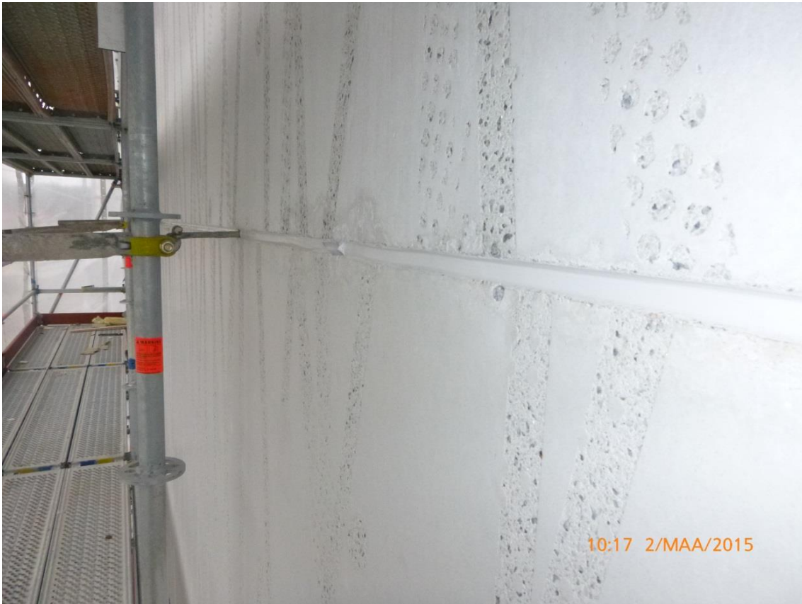
KUVA 3. Elementtien saumaus jouduttiin jättämään vajaaksi telinerunkojen kiinnikkeiden takia
