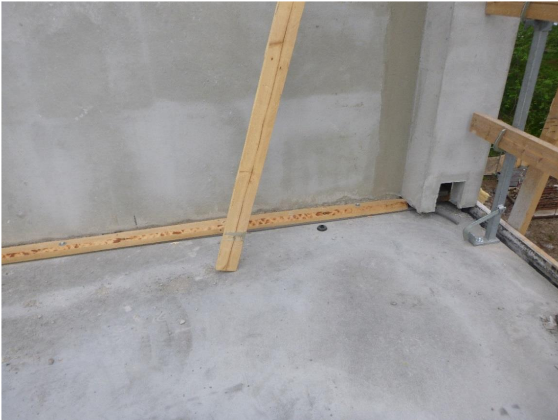
KUVA 12. Seinäelementin ja välipohjalaatan risteyskohtaan on asennettu elementtisaumanauha ja lankku ohjaamaan sadevesiä poispäin liitoksesta
