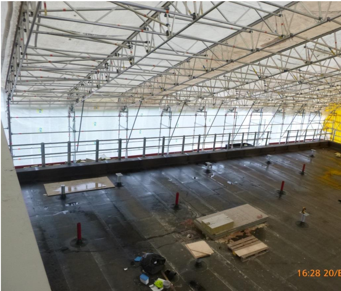
KUVA 6. Sääsuojauksen saumat ovat rankkasateen aikana vuotaneet
