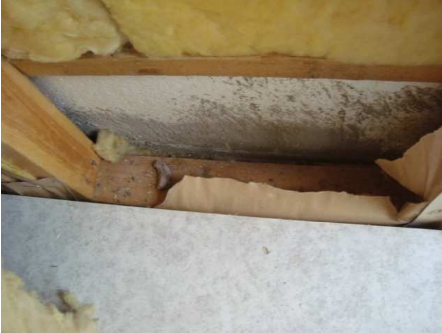
Kuva 7: Keittiön seinän alapuu kastunut
