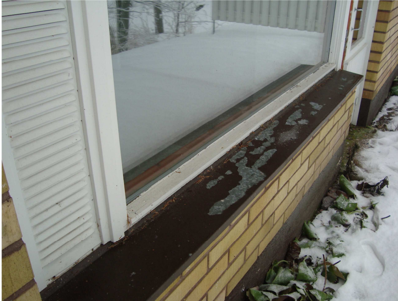
Kuva 12: Ikkunan pellityksissä hilseilyä
