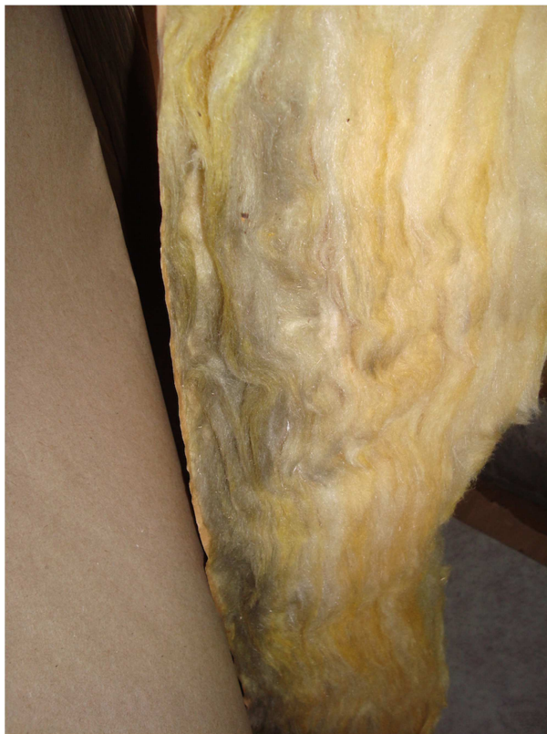
Kuva 6: Mineraalivilla kastunut seinän sisältä
