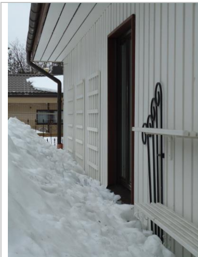
12. Talon seinustalle pak- kautunutta lunta, joka sula- essaan aiheuttaa rakentei- siin kosteusrasituksen.
