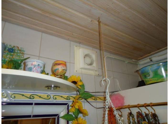
37. Poistoilmaventtiilin tilalle on asennettu sähkötoiminen tuuletin.
