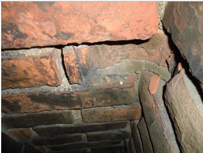
28. Hormin sisäpuolelta puuttuu paikoin laastia ja tiiliä.
