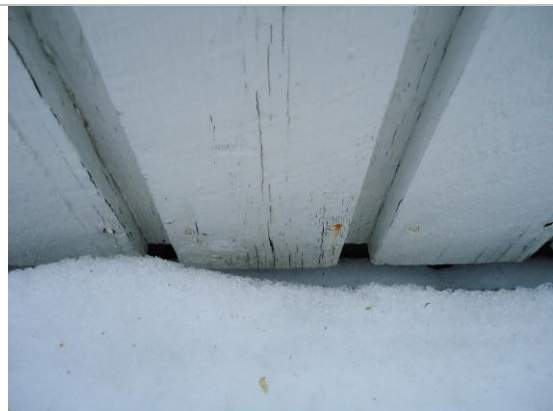
19. Maalivaurioita verhouksen alaosassa.
