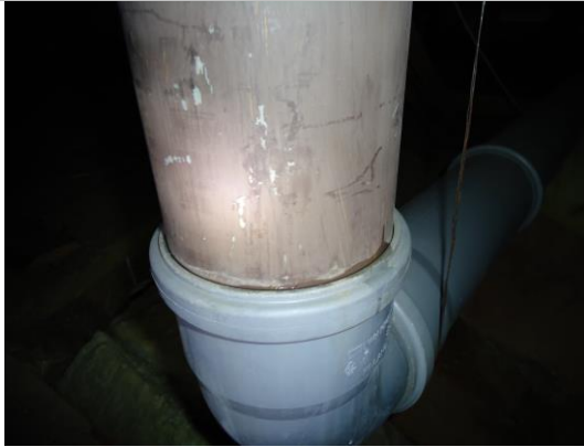
34. Eristämätön viemärin tuuletusputki ullakolla.
