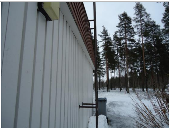
18. Eteläpuolen seinässä auringon aiheuttamia maalivaurioita.
