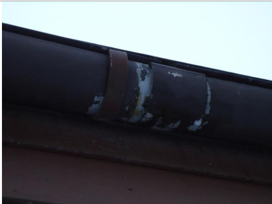
16. Vuotava liitos sadevesikourussa.
