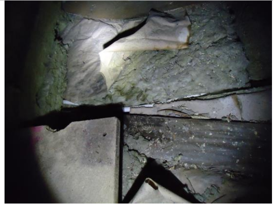
35. Eristämättömän viemärin tuuletusputken ulkopintaan tiivistynyt vesi on valuessaan kastellut alapuolella olevat eristeet.
