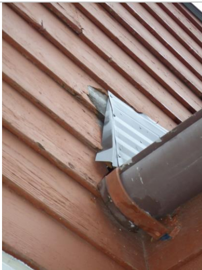
22. Kosteuden aiheuttamia vaurioita talon päätykolmiossa.
