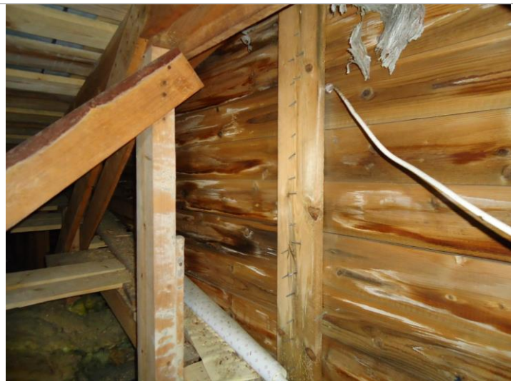
31. Päätykolmiot ovat kosteusvaurioituneet ja niihin tulee lisätä tuuletussäleiköt.
