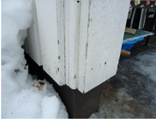
20. Maalivaurioita etupihan laudoituksessa.
