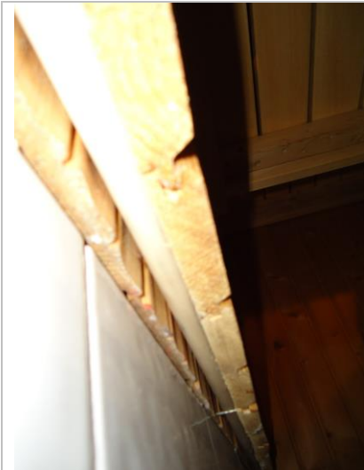
38. Paneloinnin tausta ei pääse tuulettumaan kuvassa näkyvän suojaputken ja vanhan paneloinnin takia.
