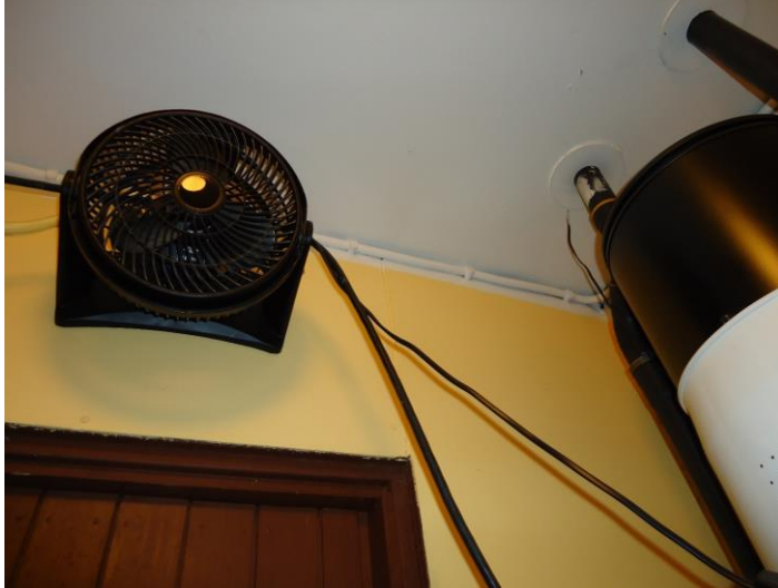
42. Ilmaa kierrättävä tuuletin on sijoitettu oven päälle.
