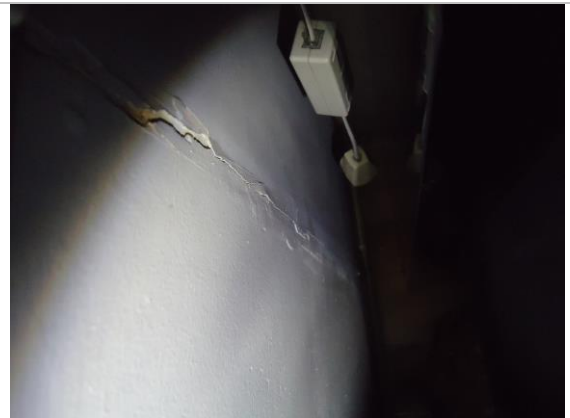
41. Yhden makuuhuoneen ikkunan alla havaittiin vaurio levysaumassa.
