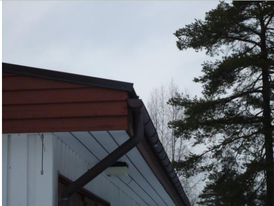
14. Vesi syöksyy liian pienen ja huonossa paikassa sijaitsevan sadevesikourun yli.
