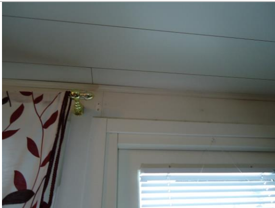
40. Terassin oven yläpuolella havaittiin vaurio.
