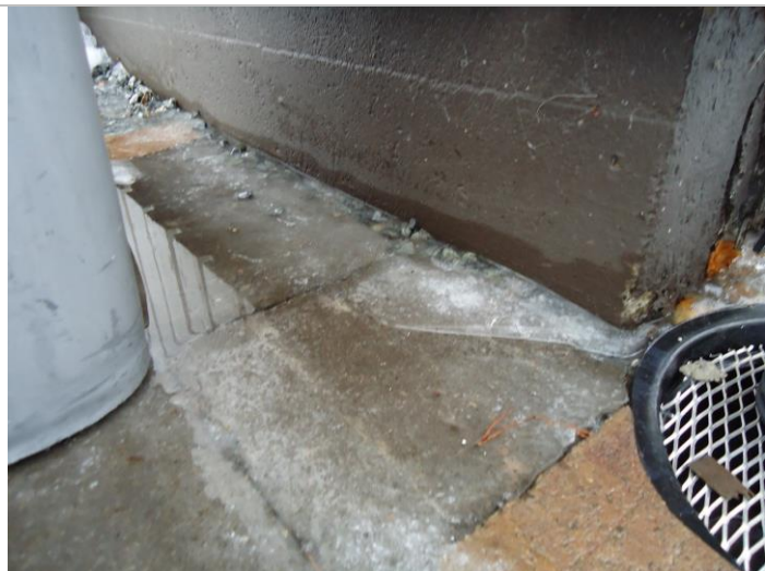
13. Vedet seisovat paikoin rakennuksen vierus- toilla.
