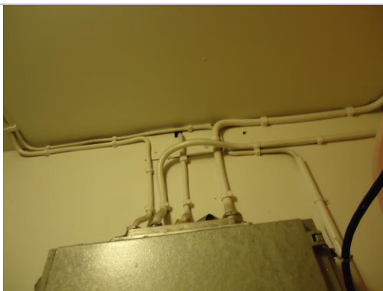
44. Läpiviennit ovat epätiivitä.
