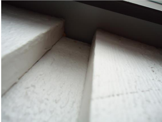
24. Ikkunapellin ja ulkoverhouksen liitoskohta, josta puuttuu tuuletusrako.
