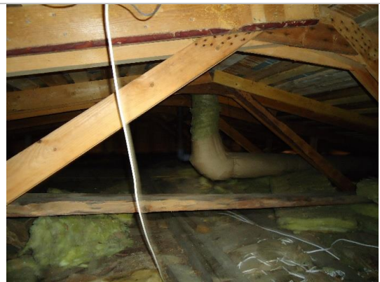
33. Vaakaveto ei toimi painovoimaisessa ilmanvaihdossa.
