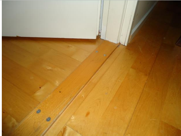
46. Sisäovien siirtoilmaraot eivät ole riittävät.
