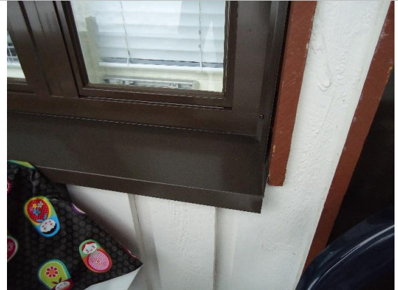
25. Riittävät kallistukset ikkunapelleissä.
