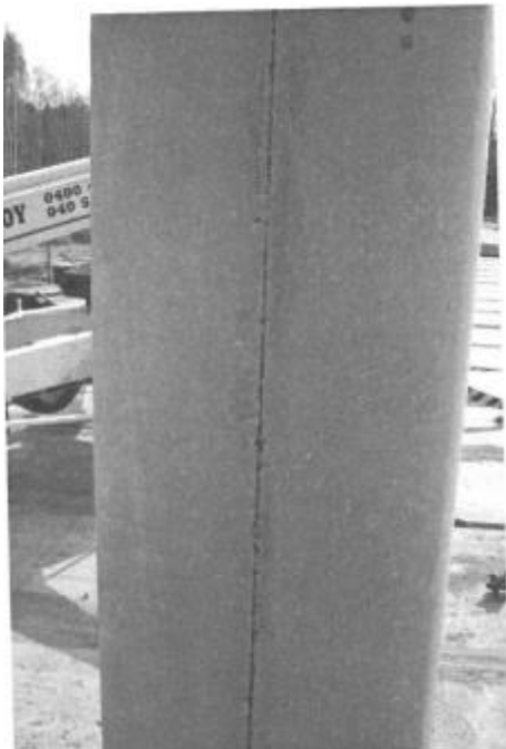
Kuva 14 Muotin tiiveyden puutteiden takia muotin saumakohta jäi näkyviin [14, s. 79.]
