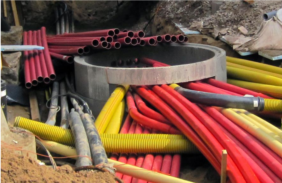
KUVA 6. Betoninen kaapelikaivo Rotuaarilla (26)
