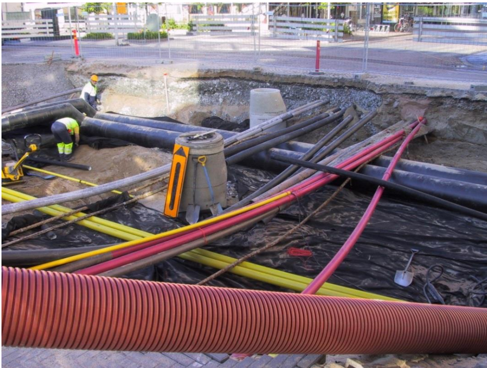
KUVA 3. Kaapeleita suojaputkissa keskustassa (12)
