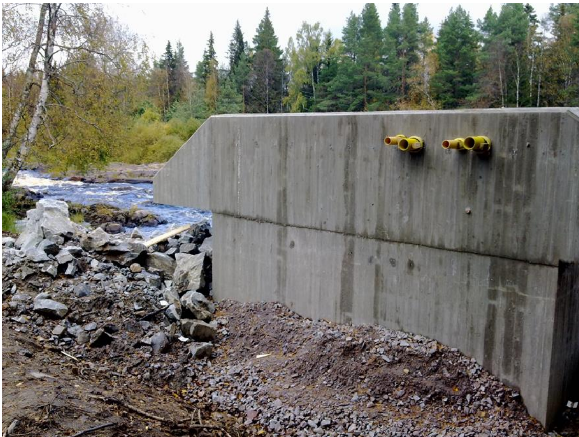
KUVA 15. Varausputkia data- ja sähkökaapeleille
