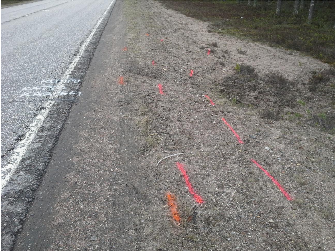
KUVA 11. Tietoliikennekaapelit lähellä vanhaa päällystettä rummun kohdalla
