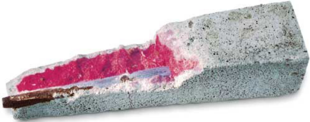
Kuva 8. Fenoliftaleiini reagoi alkalisessa pH >9 ympäristössä muuttaen betonin punaiseksi. Värjäytymätön osa betonista on karbonatisoitunut. [7.]
