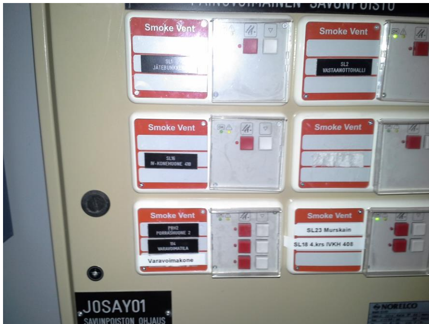
Kuva 10. Savunpoiston ohjauskeskus JOSAY01
