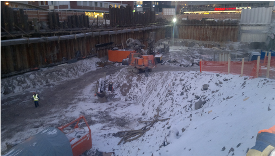
KUVA 8. Kuvassa kaapelimatto roikkuu kannattimien varassa
