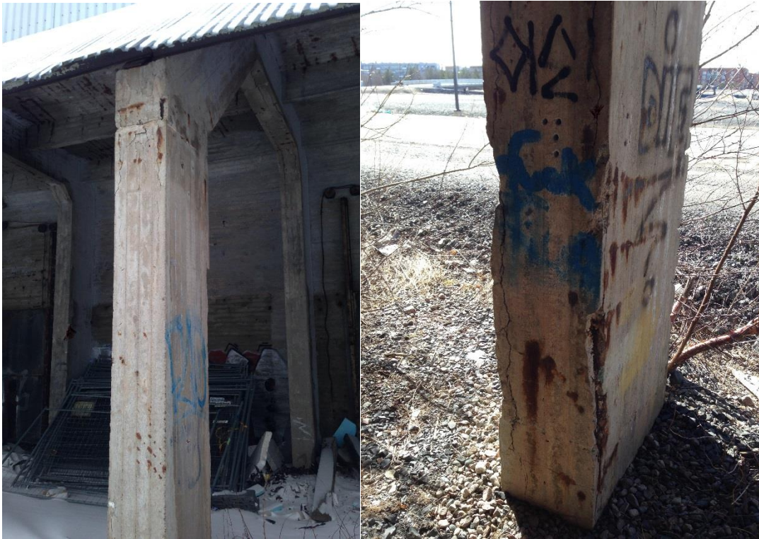
KUVA 6. Halkeilua, ruosteläikkiä ja maalauksia lounaan puoleisissa pilareissa
