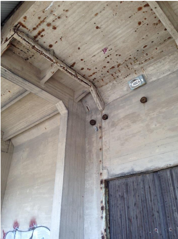
KUVA 4. Ruosteläikkiä ja näkyviä raudoitteita välipohjassa
