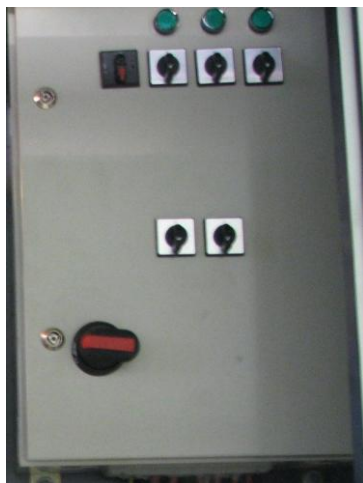
KUVA 7. Pääkeskuksen käyttökytkimet ja merkkivalot
