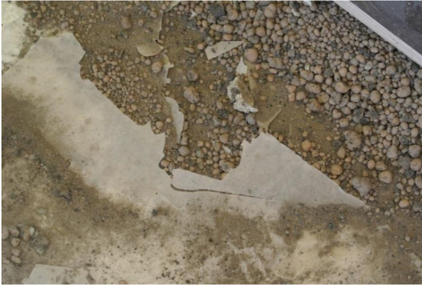
KUVA 22. Repeytynyt muovinen höyrynsulku 17.3.2015
