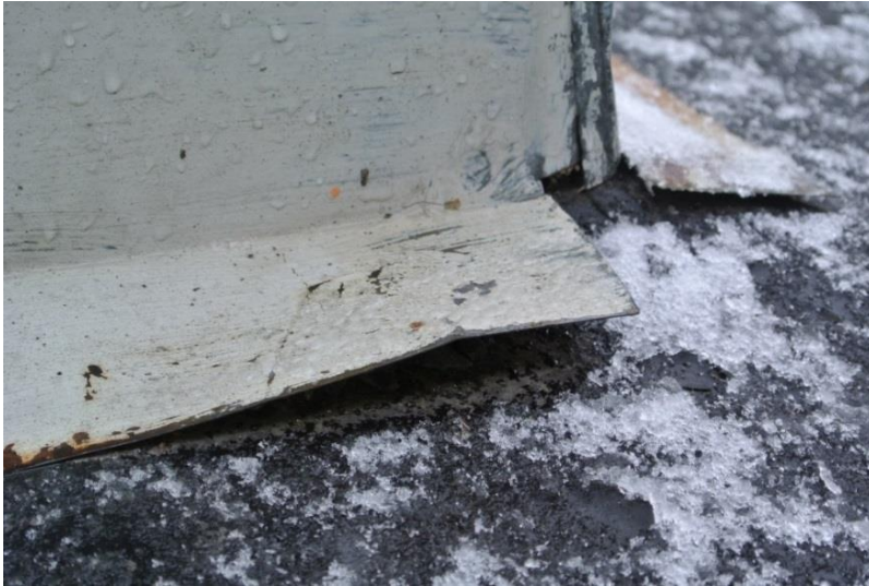
KUVA 10. Rakennusvaiheen I katolla olevan läpiviennin kermistä irronnut suo- jaus 24.3.2015
