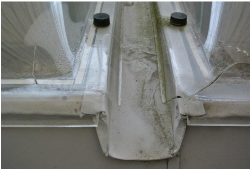
KUVA 11. Kattoikkunoiden haljenneet nurkat rakennusvaiheen I katolla 24.3.2015
