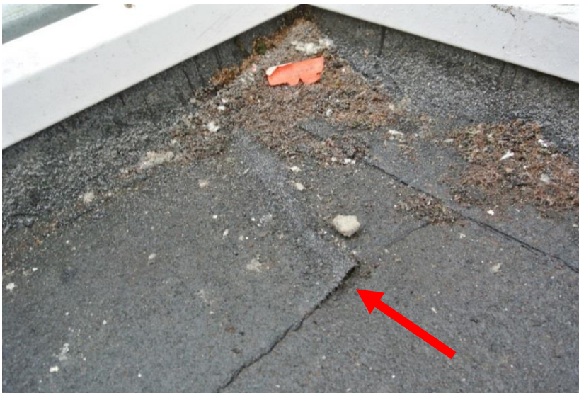
KUVA 9. Rakennusvaiheen I katolla nurkan lähellä oleva osittain irronnut kermi 24.3.2015. Kuva-alueen vesikate on uusittu vuonna 1996
