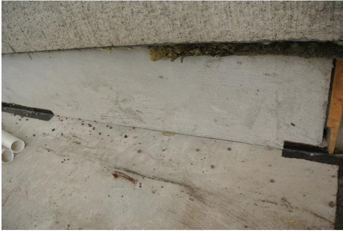
KUVA 29. Tiivistämätön seinän ja TT-laataston kohta 15.4.2015 rakennusvaiheella I
