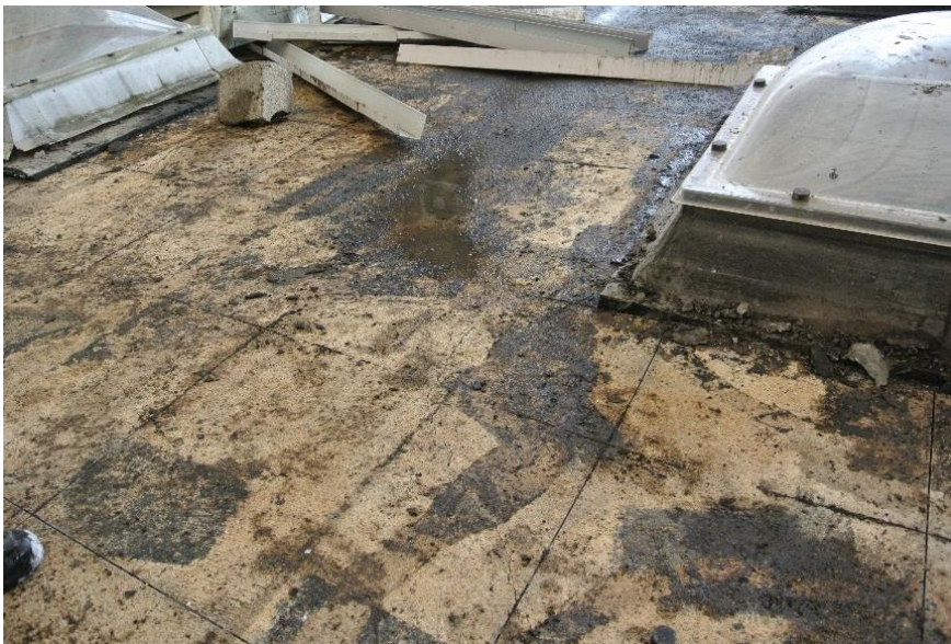
KUVA 23. Purkua varten ruuduiksi sahattu tasausbetoni 17.3.2015, jossa vanhoja halkeamia ja painumakohta, joka aiheutti lammikoitumista sateella
