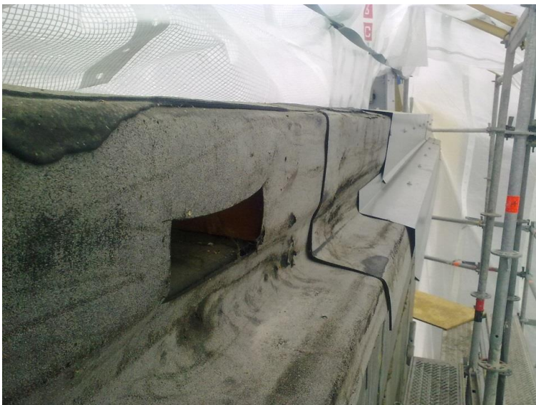
KUVA 15. Vuonna 2010 LTM-Rakennus Oy:n kunnostama porrashuoneen katto, jonka tuulettuminen oli edellisessä korjauksessa estetty pellityksellä (Hyvärinen 2015)
