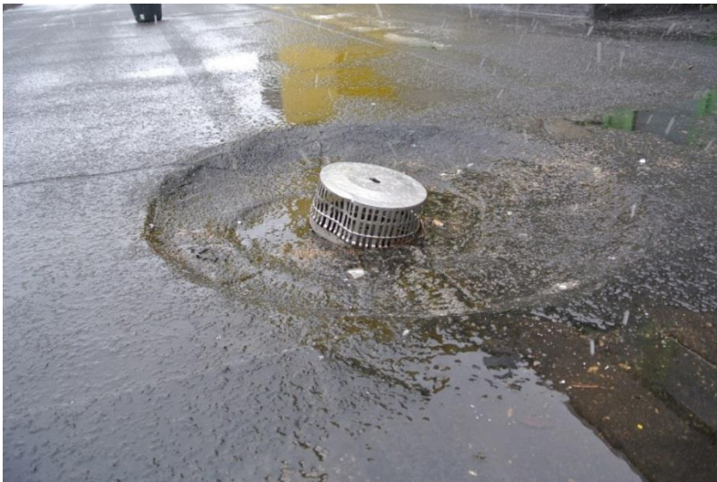
KUVA 13. Vaurioitunut kattokaivo rakennusvaiheella I. Vettä lammikoituu myös kaivon viereen 24.3.2015
