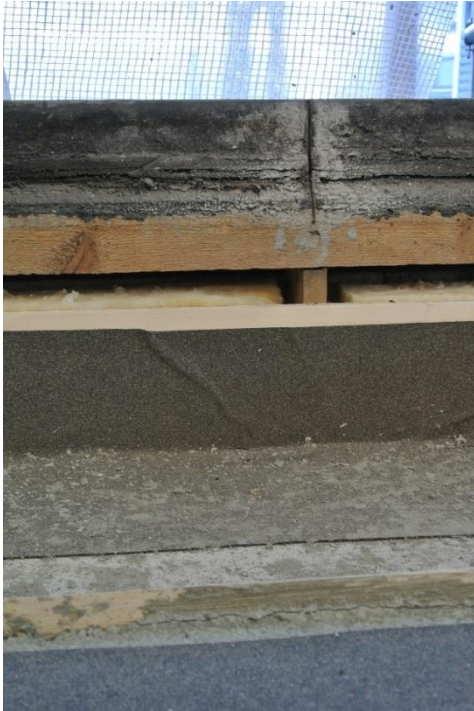
KUVA 28. Höyrynsulkukermin asennus liian matalaksi jäävälle räystäälle 17.4.2015
