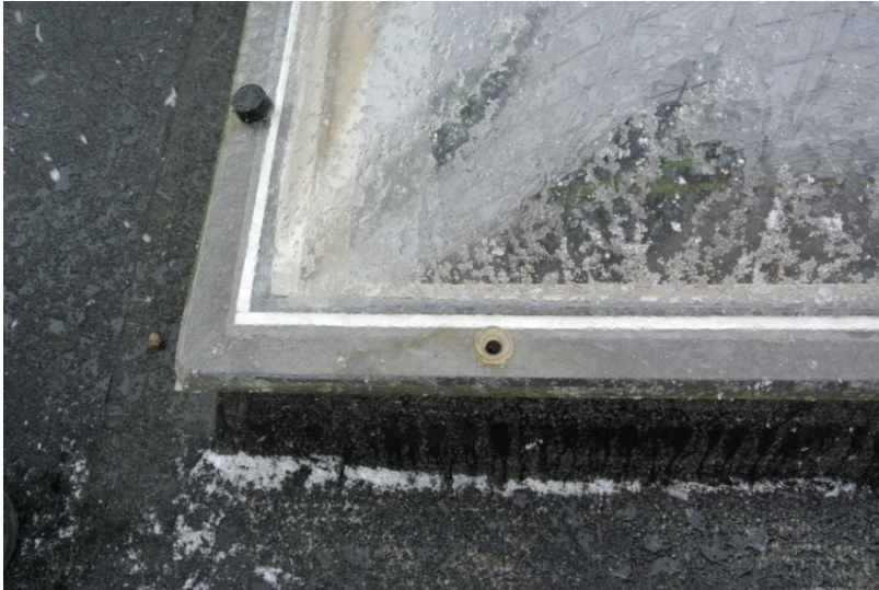
KUVA 12. Puuttuva kiinnitysruuvin suojatulppa rakennusvaiheen I katolla 24.3.2015
