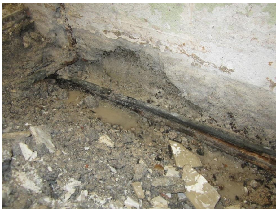
Figur 11. Läckande värmerör pga. sönderrostad gjutjärnsgolvbrunn. En "tickande bomb" som kanske skulle blivit upptäckt om man valt en alternativ saneringsmetod.
