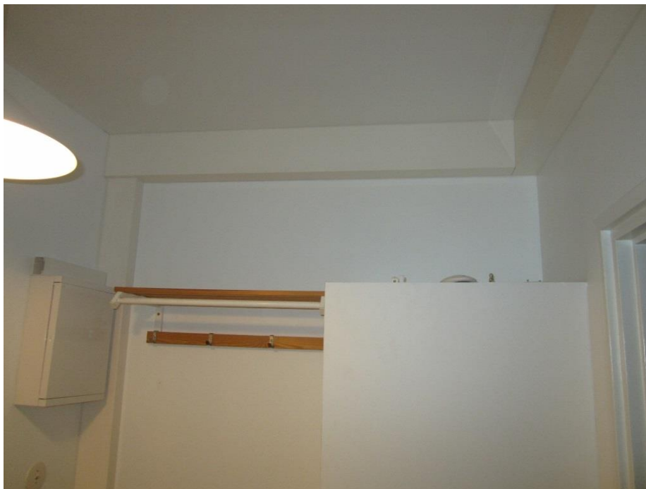
Figur 12. Ny gruppcentral med plastkaneler innehållande bruksvattenrör mellan badrum och kök samt matarkablar till badrummet.
