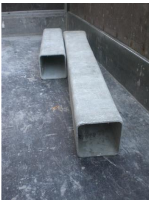
Figur 2. Ventilationsrör av asbestcement.
