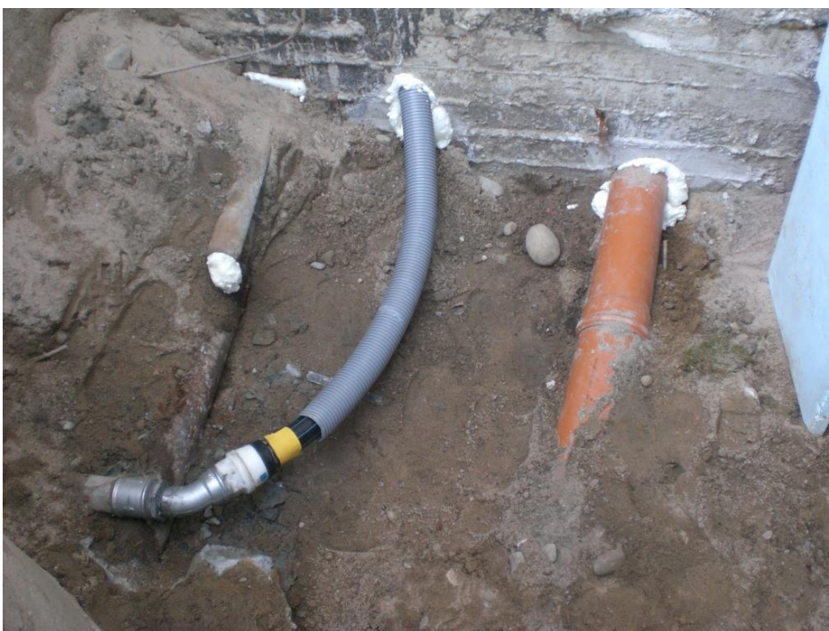
Figur 21. Ny inkommande vattenledning 21
