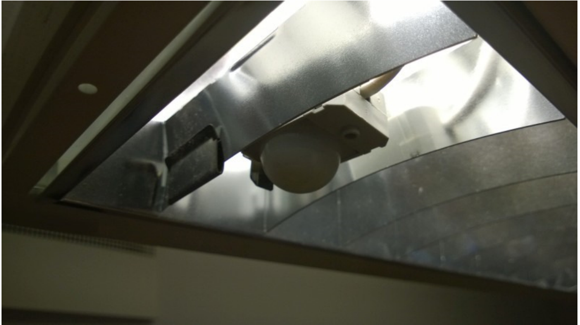
Kuva 11. iDim Sense -sensori asennettuna valaisimeen.
