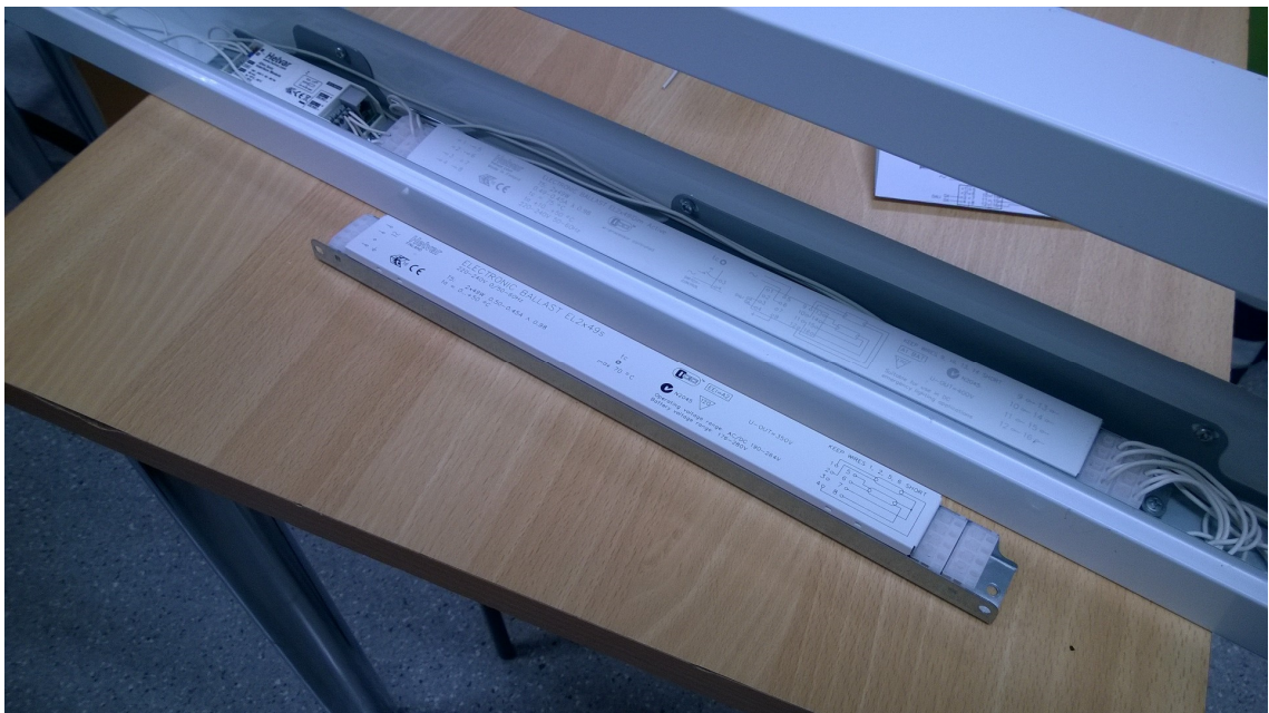
Kuva 9. Uudet komponentit asennettuna valaisimeen. Valaisimen ulkopuolella vertailun vuoksi vanha liitântälaite.
