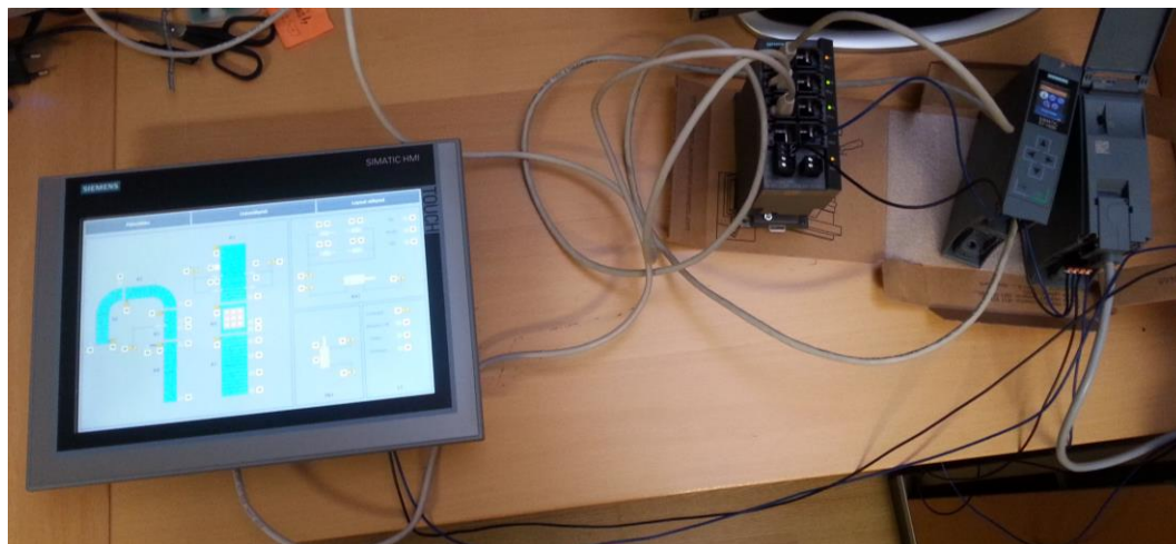
KUVA 6: Paneelin ja PLC:n välinen yhteys testauksessa
