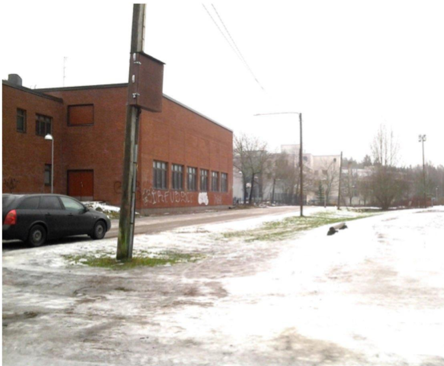
Kuva 20. Pylvääseen asennettu keskus ja sen ympärillä sääsuoja, joka on valmistettu vesivanerista. (Kuva: Noora Hiltunen)
