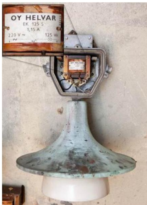
Kuva 30. Elohopeahöyryvalaisimen kuristin on asennettu omaan koteloonsa
