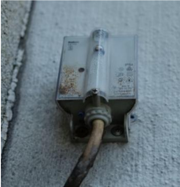
Kuva 38. Ulkotilaan suunniteltu hämäräkytkin, jonka sisällä on kosteutta
