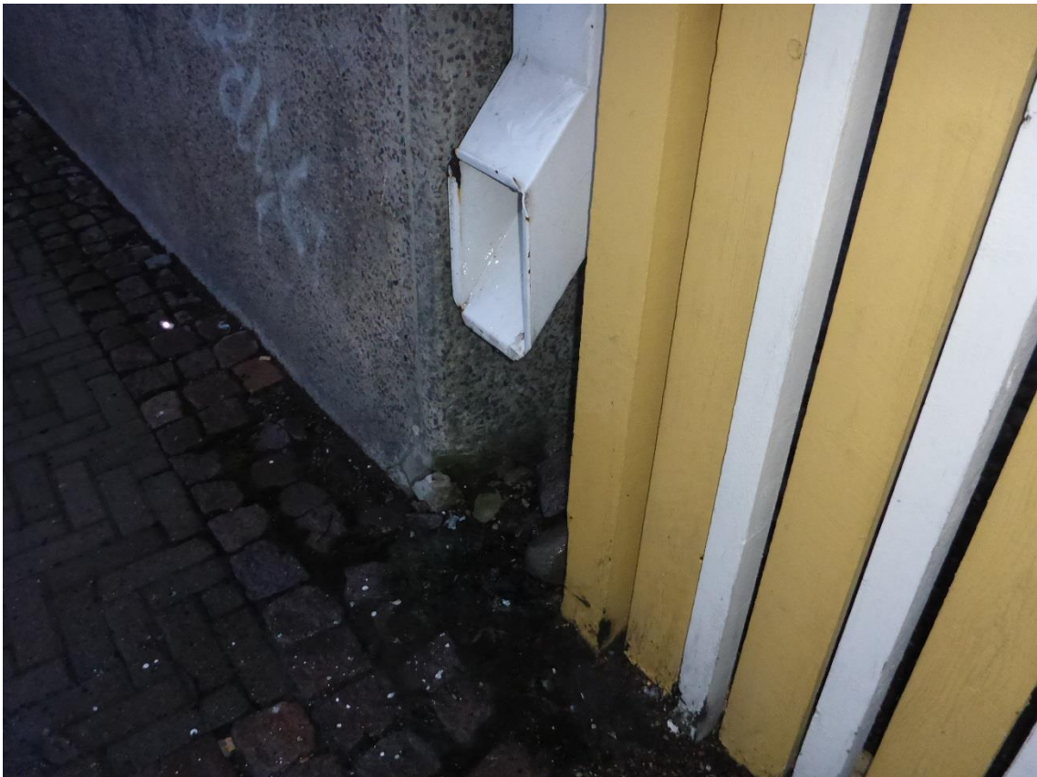
KUVA 6. Perustus on rapautunut nurkista ja aidan alapää on kiinni maassa
