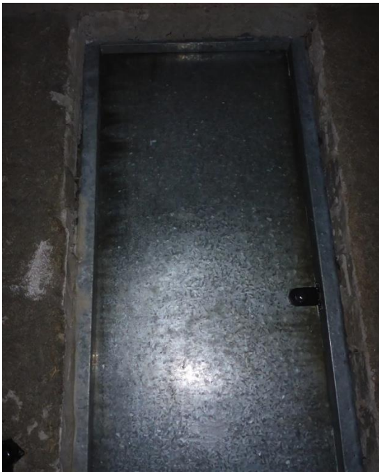
KUVA 8. Ullakolle johtavassa ovesa ilmavuodon aiheuttamaa likamuodostumaa
