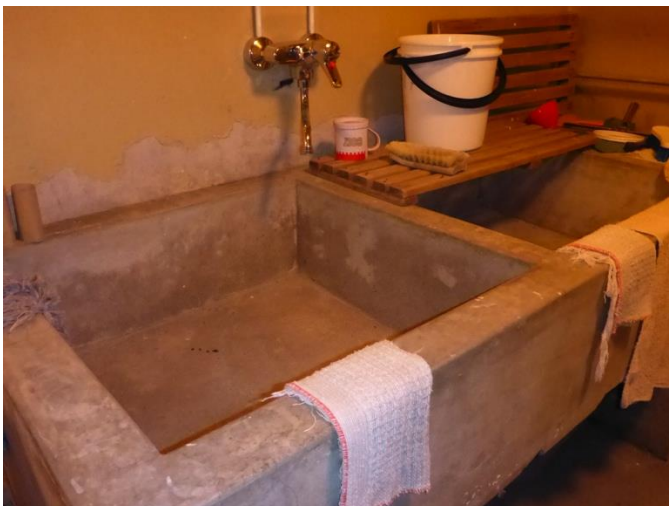
KUVA 12. Pesutuvan alkuperäinen betoniallas ja rapautunutta maalipintaa
