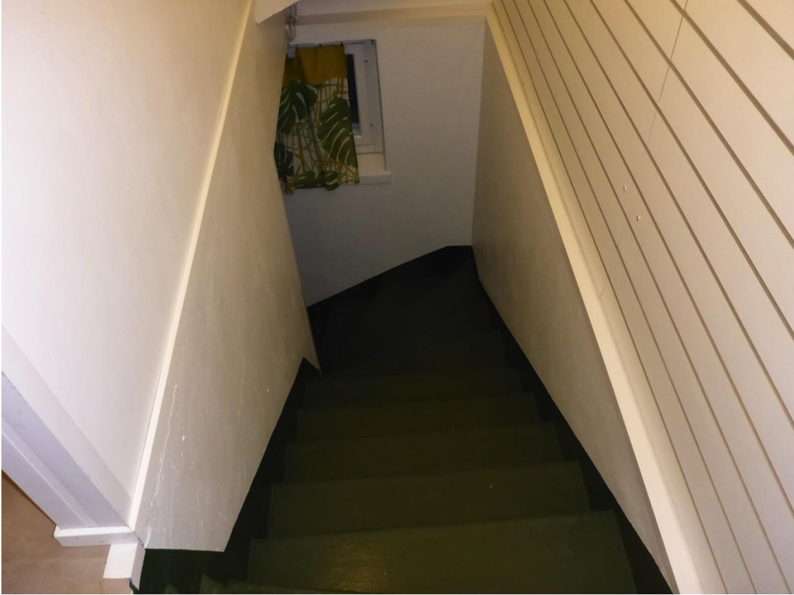
KUVA 3. Liikehuoneiston portaikosta puuttuu käsijohde
