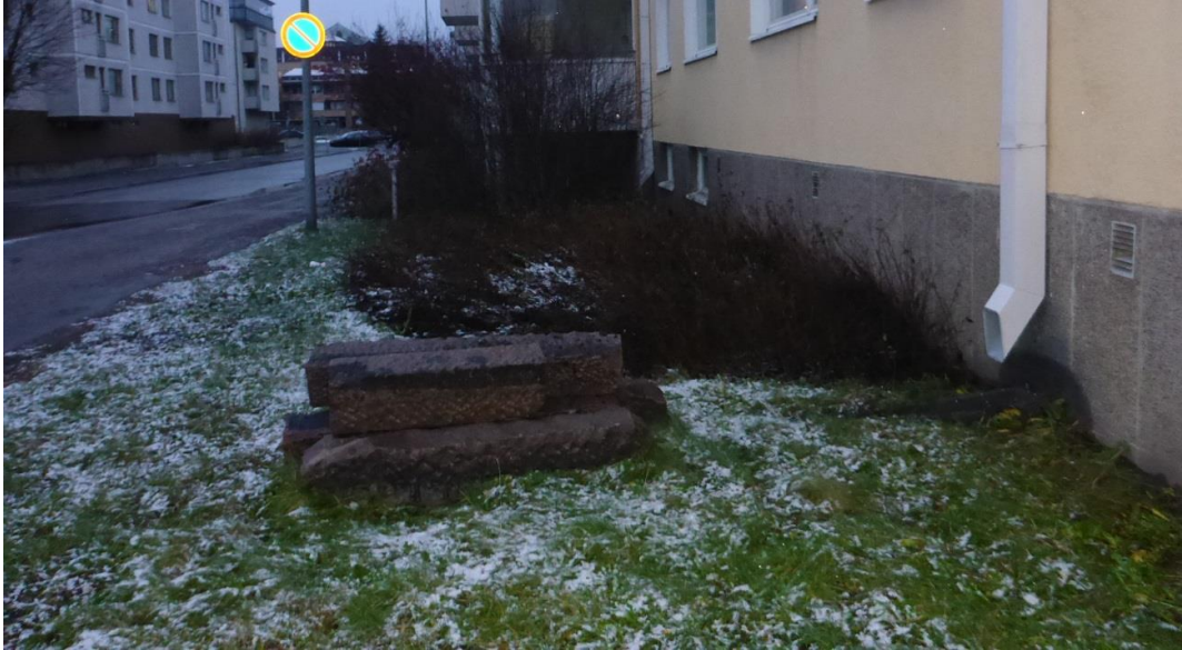
KUVA 4. Pensaat kasvaa kiinni seinässä ja pinta viettää rakennukseen päin
