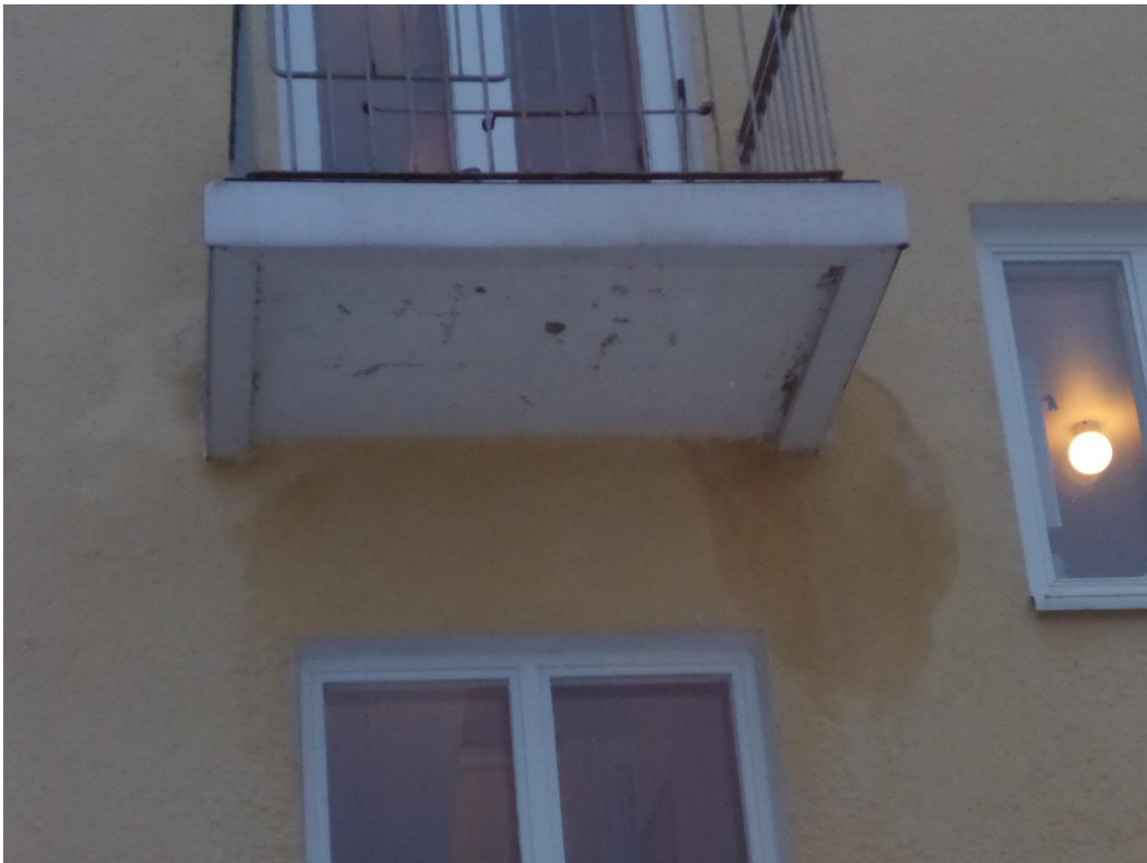
KUVA 7. Seinän rappaus märkänä tuuletusparvekkeen vierestä
