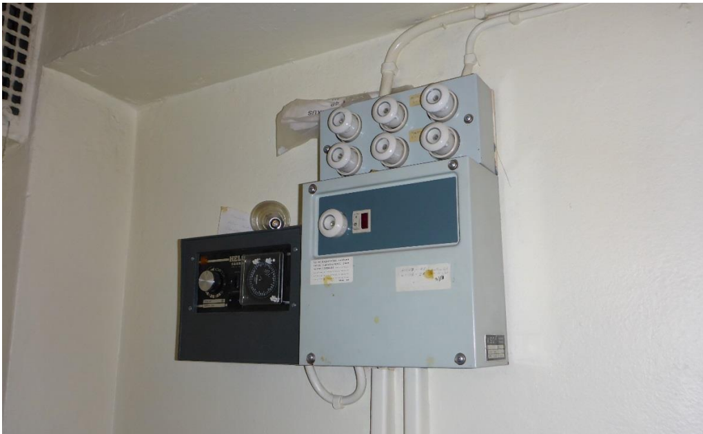
KUVA 17. Kiukaan ohjauskeskus ja sulakkeet
