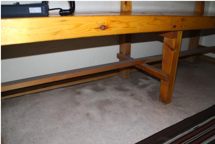
KUVA 11. Pukuhuoneen tummunut matto, josta saatiin pintakosteusmittarilla kohonneita kosteusarvoja
