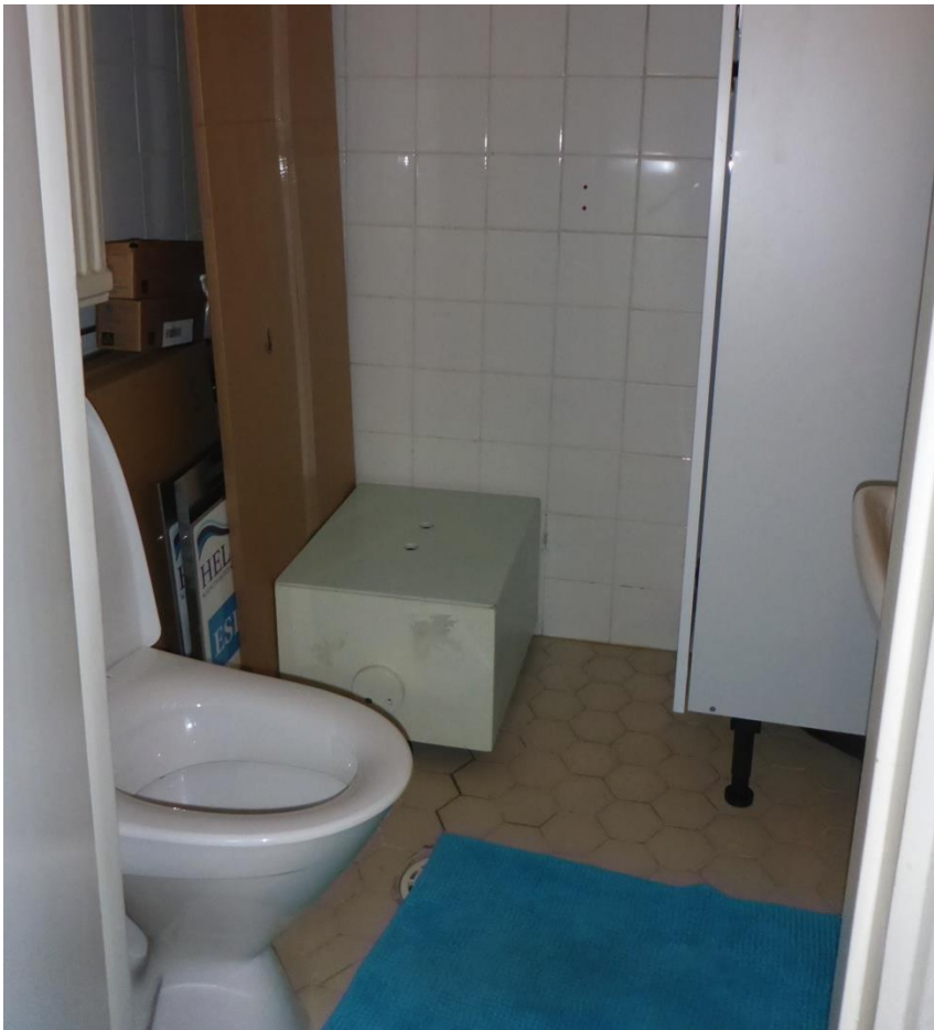
KUVA 14. Käytöstä poistettu kylpyhuone
