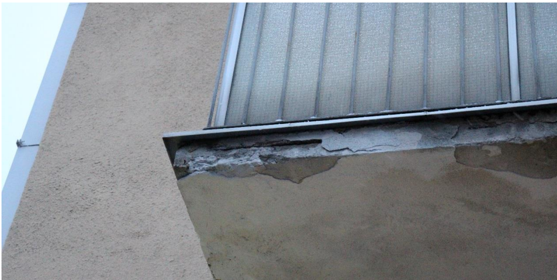
KUVA 9. Asuntojen parvekkeiden reuna on pahoin rapautunut
