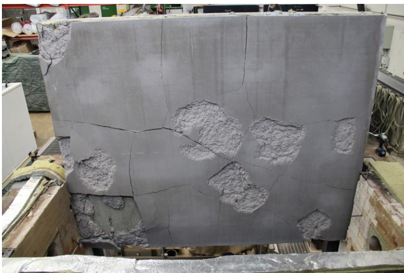
KUVA 21. Betonirakenteen hallitsematon lohkeilu
