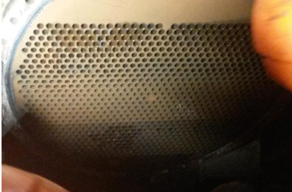
Kuva 5. Kuivaamon lämmönvaihtimen putkistoa vaihtimen sisältä (Kuva: Petri Vanninen) .
