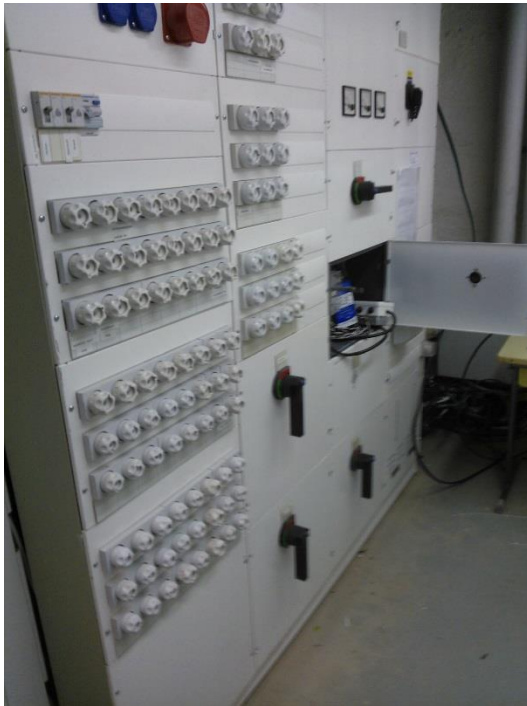
Kuva 14. Pohjois-lin koulun sähköpääkeskus
