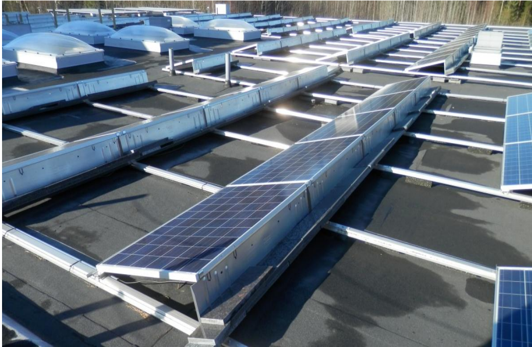
Kuva 5.2 LUT kampus Lappeenranta aurinkovoimala. (Linnamurto 7.4.2014)
