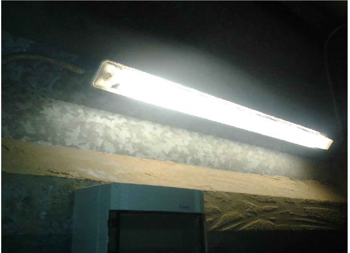
Kuva 6. Tilan 3 valaisimen suojaus
