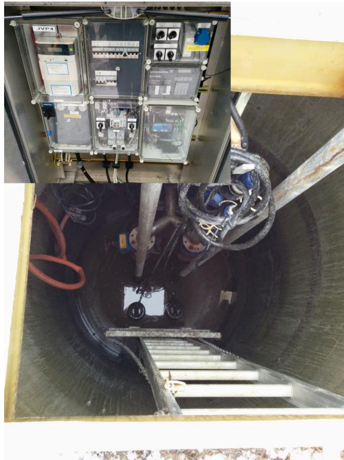
KUVA 1. Yleisimmin käytössä oleva jätevesipumppaamotyyppi
