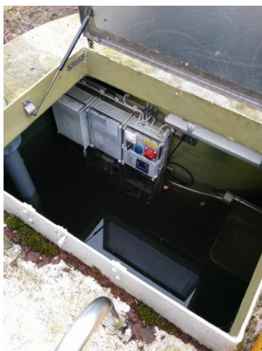
KUVA 4. Pahoin tulvinut jätevesipumppaamo
