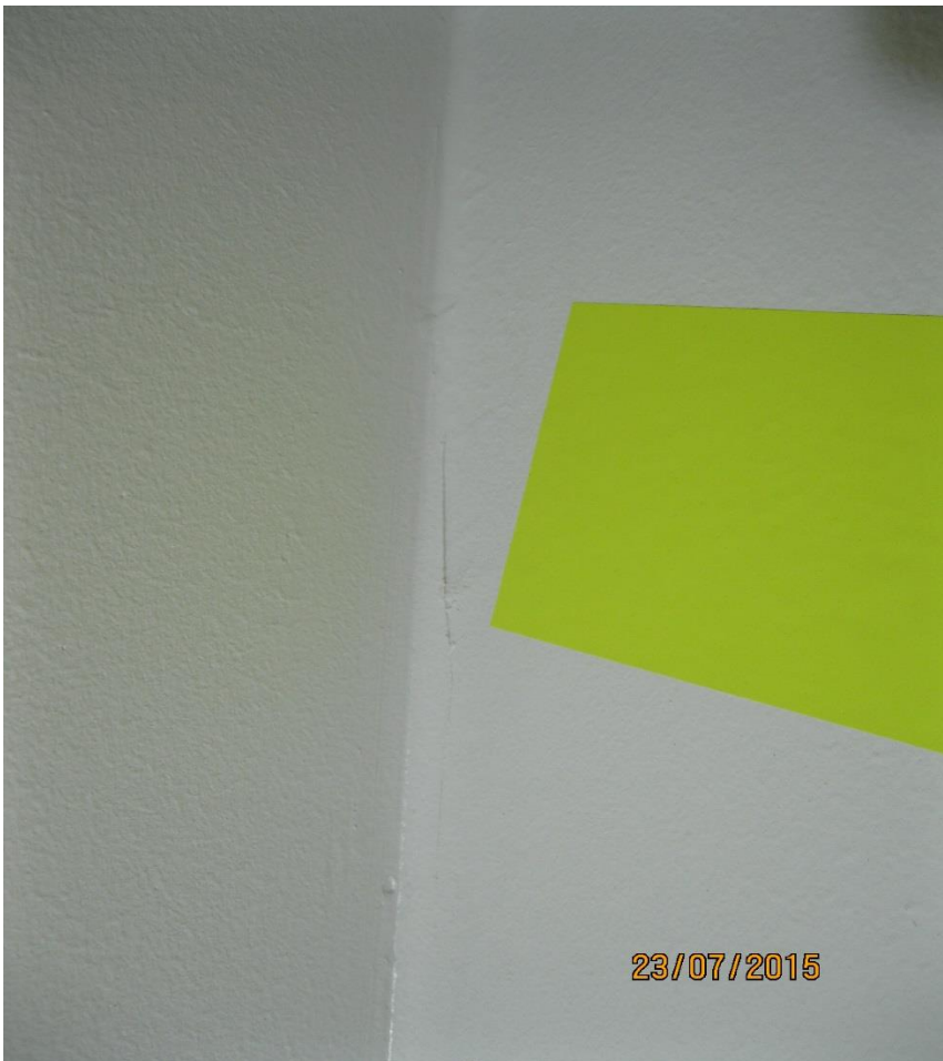
KUVA 20. Valumajälkiä ja naarmuja maalipinnassa
