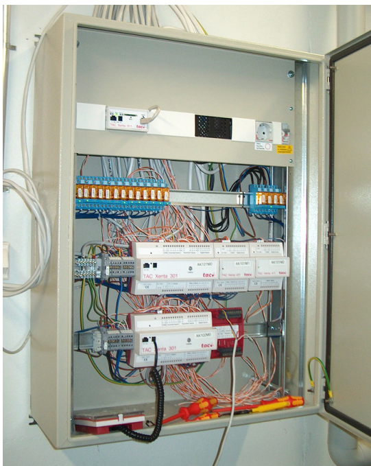
Kuva 4 TAC:n alakeskus lämmönjaossa.
