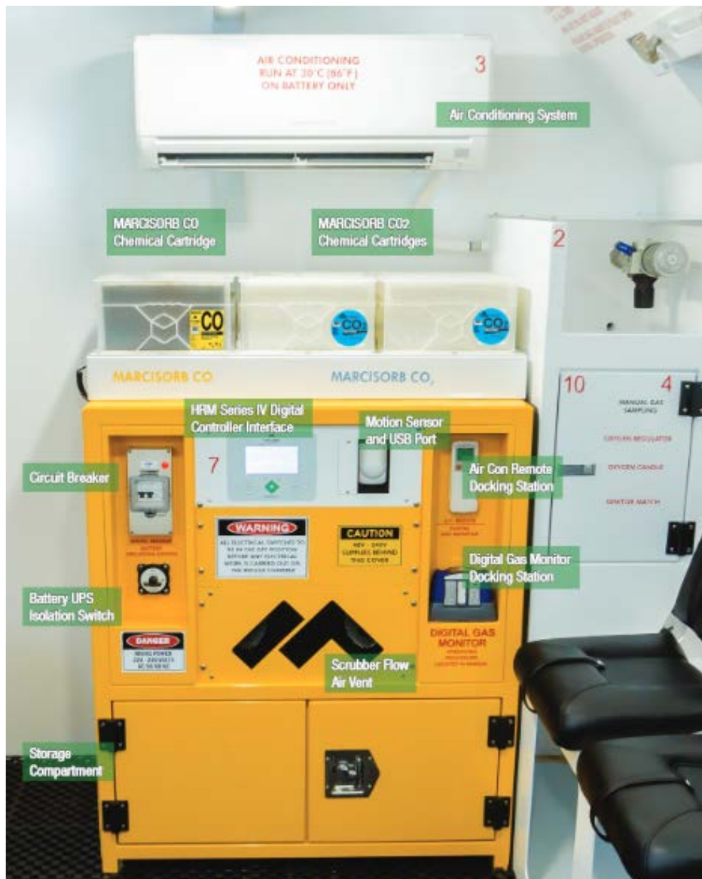
Kuva 3 Metall- ja ei-metallikaivoksille tarkoitetun suojatilan varustelua, muun muassa ilmastointilaitte, ilmastoinnin valvontalaite, kemikaalipakkauksia, digitaalinen kaasunvalvontalaite, suojakatkaisin, ja säilytyslokero. (MineARC Systems 2015b)
