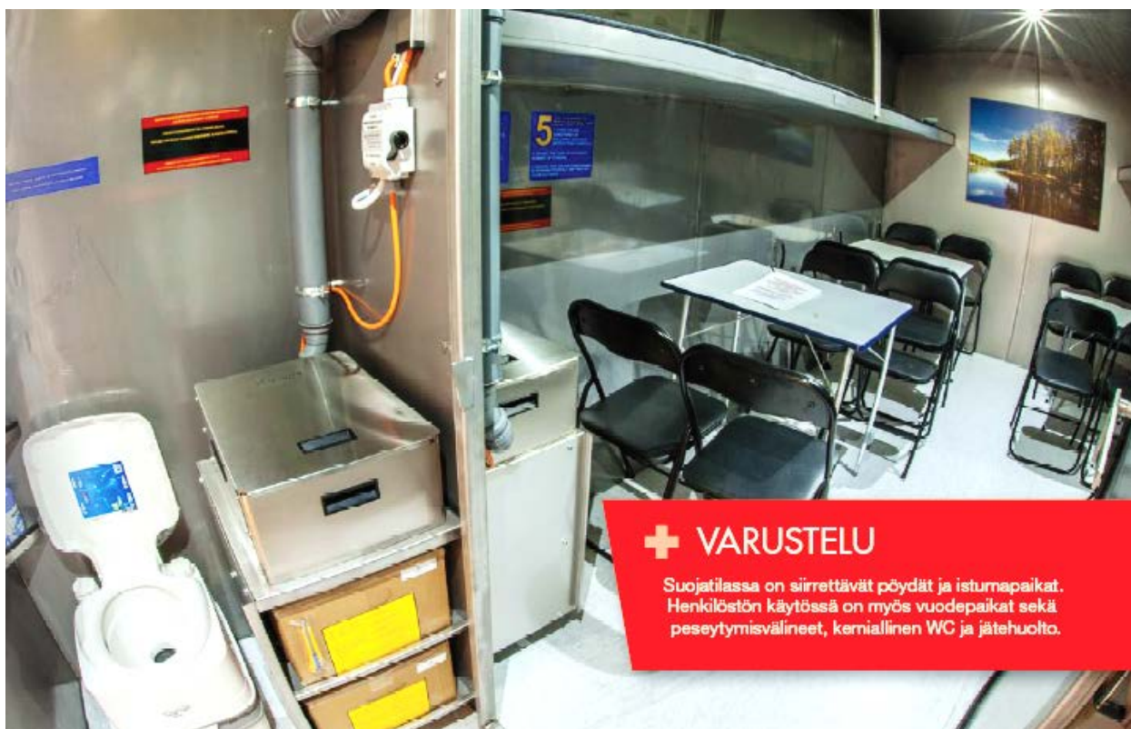
Kuva 14. Suojatilan varustelua (Heat-It 2014)
