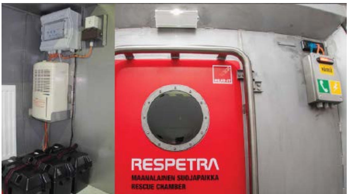
Kuva 13. Suojatilan varustelua (Heat-It 2014)
