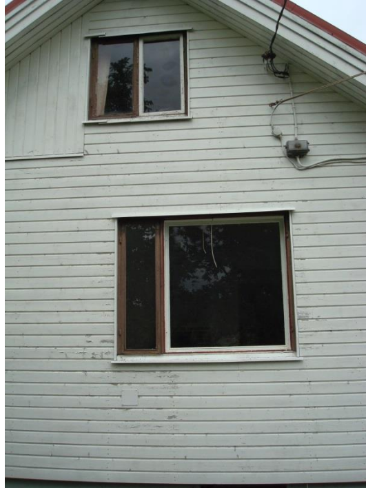
Kuva 5: Maalausta vailla oleva julkisivu sekä yläkerran ikkuna.
