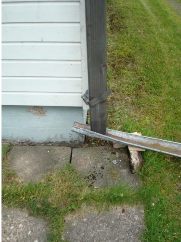
Kuva 4: Puutteellisesti toteutettu sadeveden poisto
