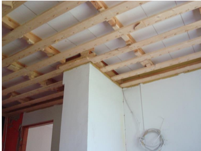
Kuva 9: Paloturvallisuusmääräysten vastaisesti tehty piipun ja katon liittymäkohta.
