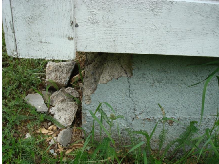
Kuva 2: Perusmuuri on paikoitellen halkeillut.
