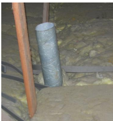
Kuva 26. Wc:n tuuletus välikatolla
