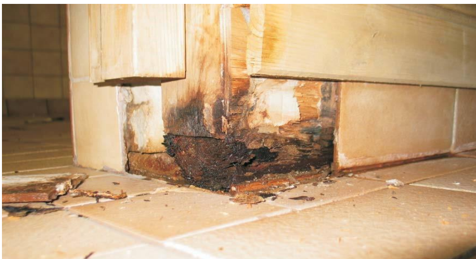
Kuva 2. Saunan ja pesuhuoneen väliseinän alapuu (Hometalkoot, pientalojen riskirakenteet )
