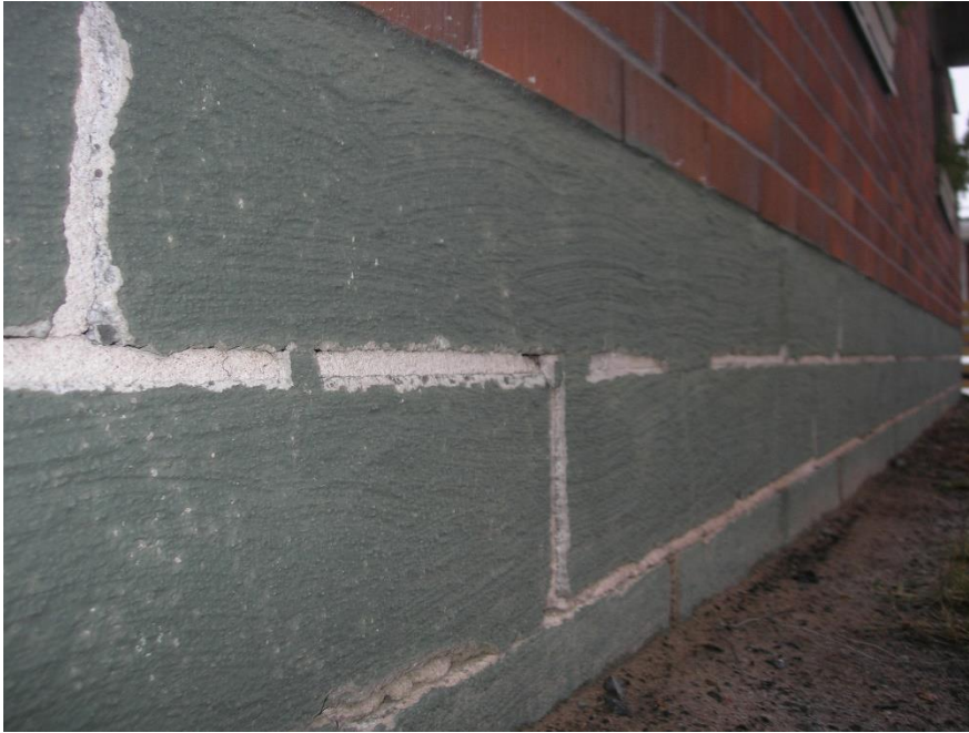
Kuva 22. Eteläseinustan rapistunutta valesokkelin pintaa
