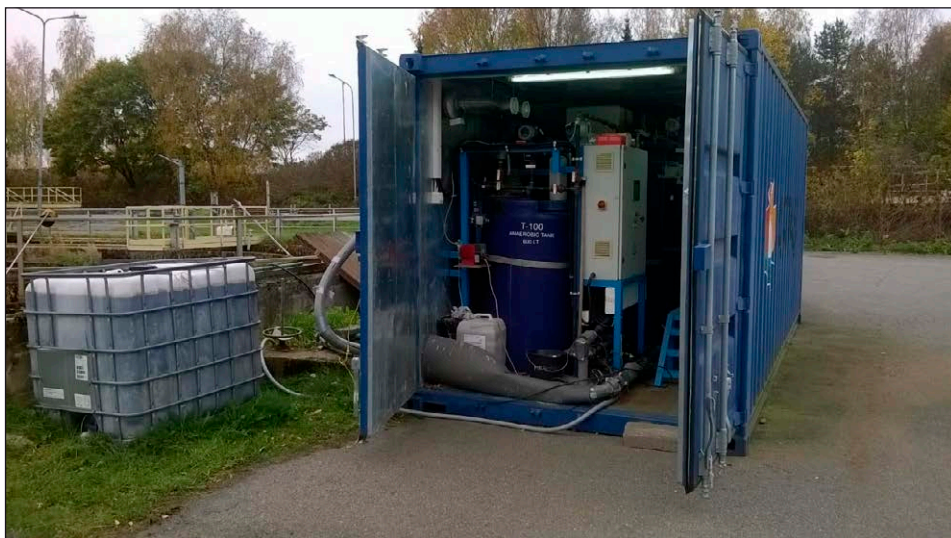
KUVA 2. MBR-teknologian kokeilua Mikkelin jätevedenpuhdistamolla (kuva Risto Repo)
