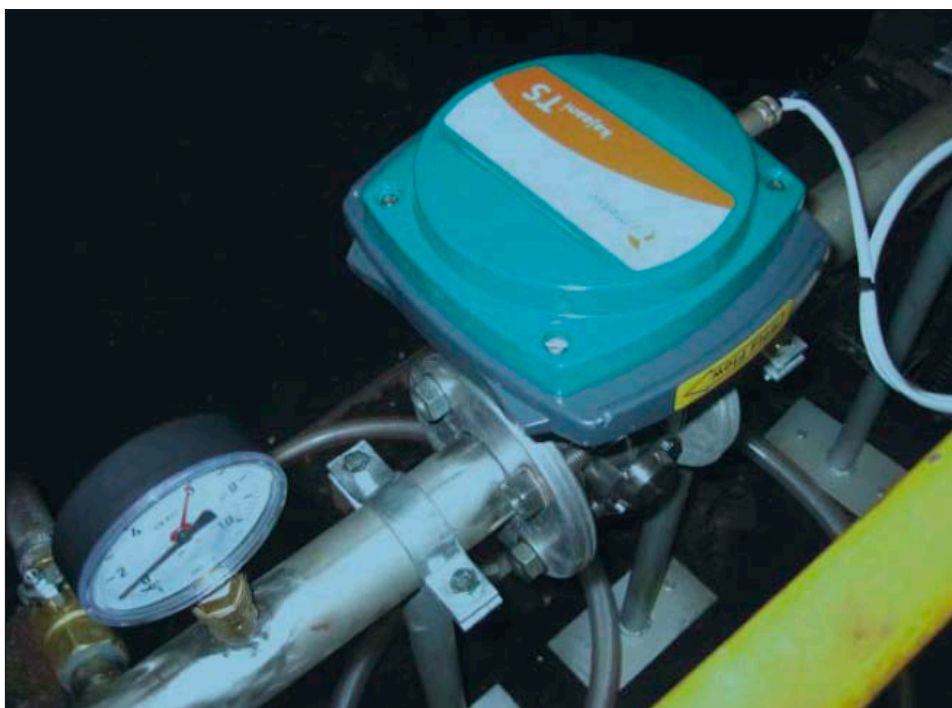
KUVA 3. Kajaani TS -mittari asennettuna DN50-putkeen (Poutiainen ym. 2009)
