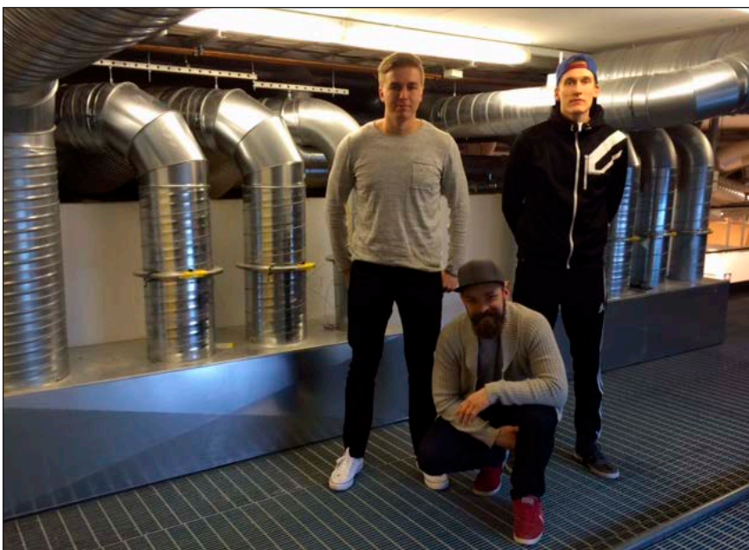
KUVA 4. Mamkin 3. vuoden talotekniikan opiskelijat Henri Järvenpää, Kimmo Laine ja Timo Kankaanpää olivat mukana suunnittelemassa Testlab-oppimisympäristöä. Opiskelijat toteuttivat myös suunnitelmansa osana opintojaan. Taustalla valmis ympäristö (kuva Johanna Arola).
