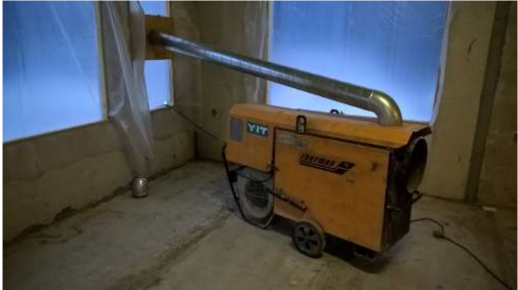
Kuva 10. 100 kW:n öljykäyttöinen lämpöpuhallin, jonka pakokaasut johdetaan putkea pitkin ulos.
