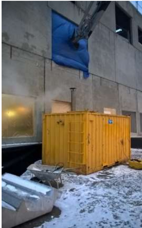
Kuva 11. Lämpökontti, jolla saadaan lämmitettyä suurta aluetta kerralla. Kuvassa lämmitetään alempaa kerrosta ylemmän kerroksen lattiavalua varten.
