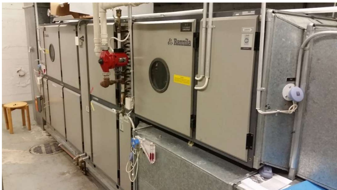
Kuva 8. Tuloilmakone 5. Jälkeenpäin lisätyt mittauspisteet näkyvät asennettuna valkoisella johdoilla.
