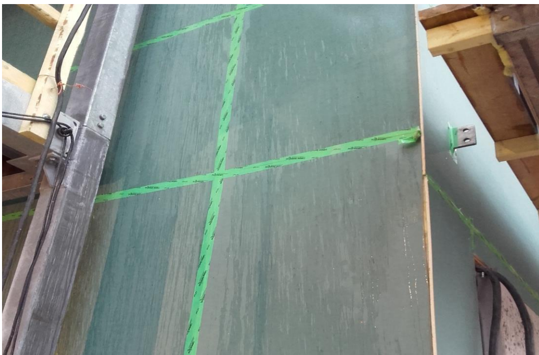
Kuva 10. Ulkoseinärakenteen kosteusrasitus. Kuva: Vesa Sainio 2016.
