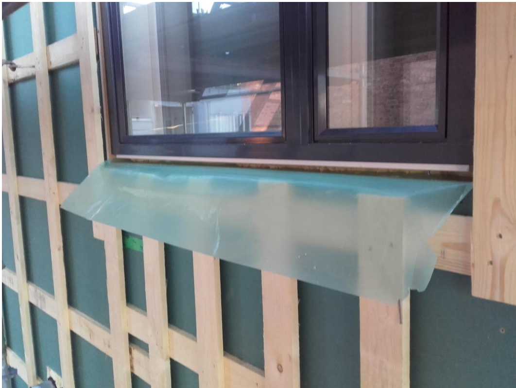
Kuva 3. Rakennusvaiheessa ulkoseinän ikkunoiden sekä parveke-ovien asennuksessa on huomioitava kosteuden kulku alla oleville rakennepinnoille siten, että kosteus ei pääse siirtymään suoraan rakenteiden väliin. Tässä tapauksessa puurakenteisen seinän ja tuulensuojan. Kuva: Vesa Sainio 2016.
