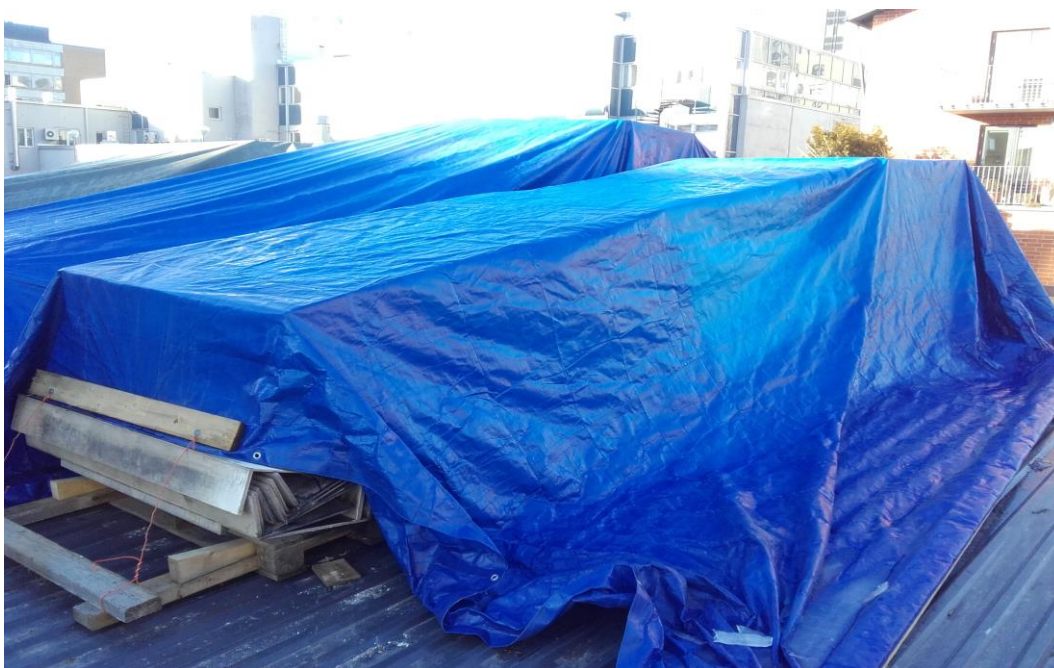
Kuva 7. Työmaalla kosteudelle alttiit materiaalit suojattu säältä ja rikkoutumiselta asianmukaisesti. Kuva: Vesa Sainio 2016.
