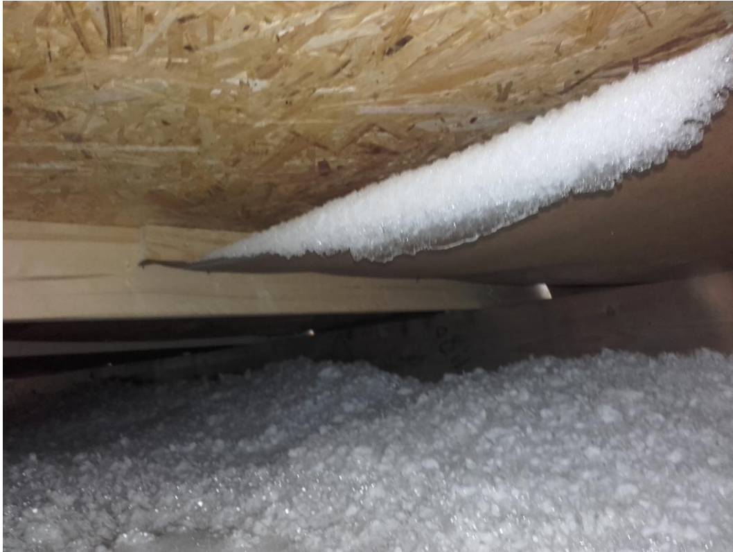
Kuva 6. Vesikaton välikattorakenteen tuulenohjainlevyyn noussut lumipyry talvimyrskyn aikana tuulenpaineen avulla. Kuva: Vesa Sainio 2017.
