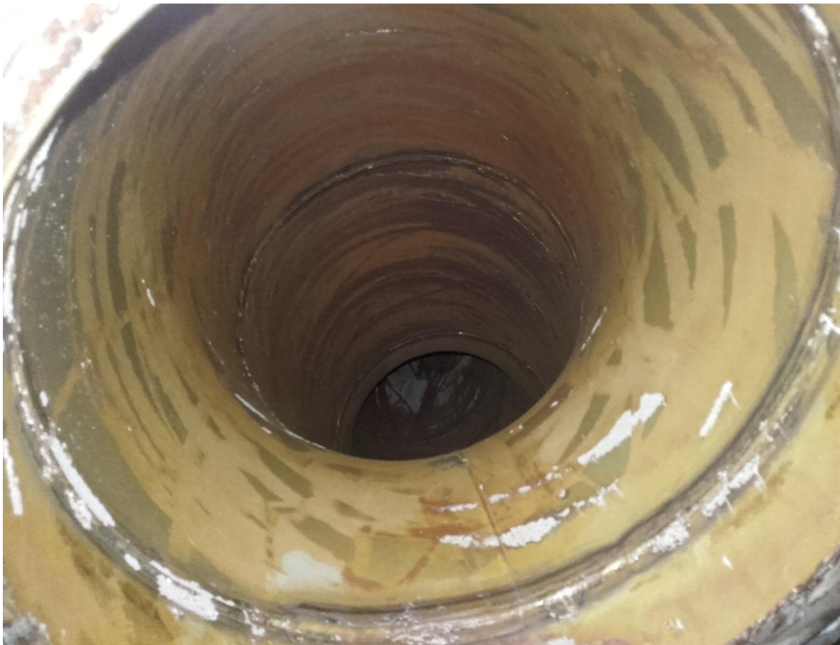
Figur 16 Rörinloppet till värmepumpen.
