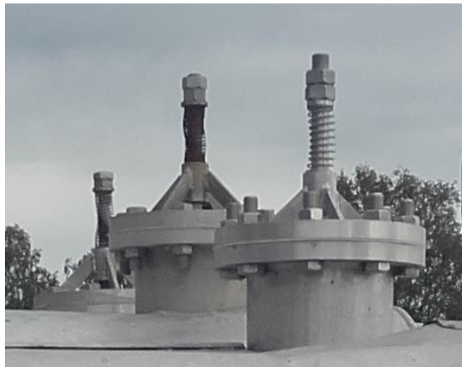
Figur 15 Vakuumentiler som är placerade på rörsystemets högsta punkt.
