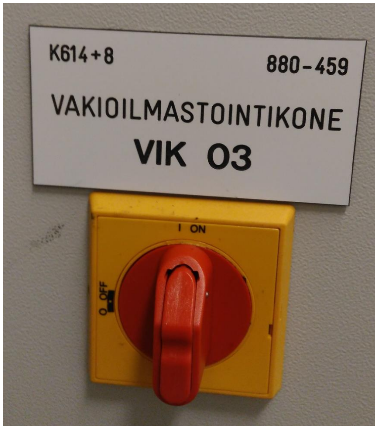
Kuva 8. Vakioilmastointikone VIK 03:n toimintopaikkakyltti
