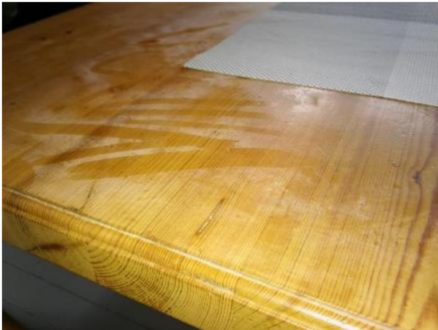
Kuva 1. Kosteutta tiivistyneenä kylmälle pöytäpinnalle rakennuksen sisällä.
