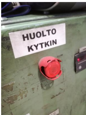
Kuva 4. Aurubixsella yleisimmin käytetyt huoltokytkimet ovat ohjauspöydälle sijoitettuja painikkeita, jotka voidaan lukita niiden ollessa off – asennossa.
