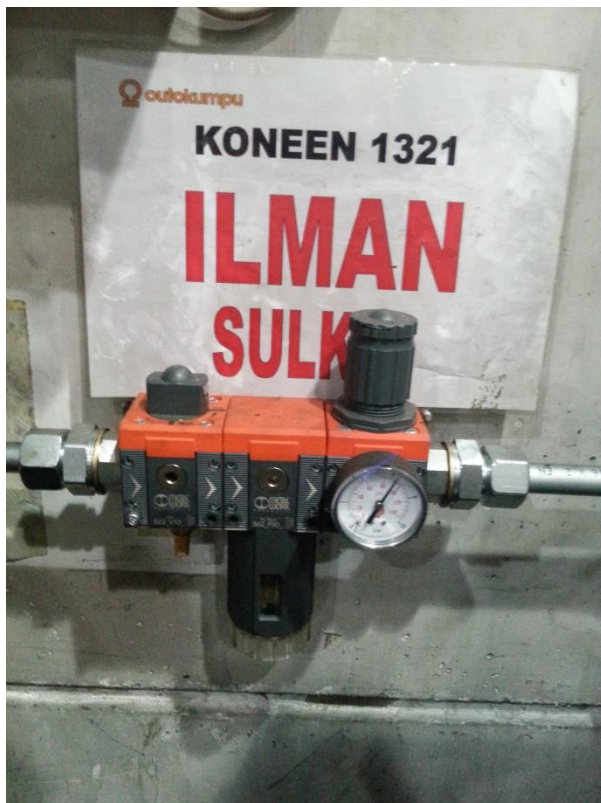
Kuva 8. Osa pneumatiikkajärjestelmien ilmansuluista on varustettu lukittavilla, paineen purkavilla venttiileillä.
