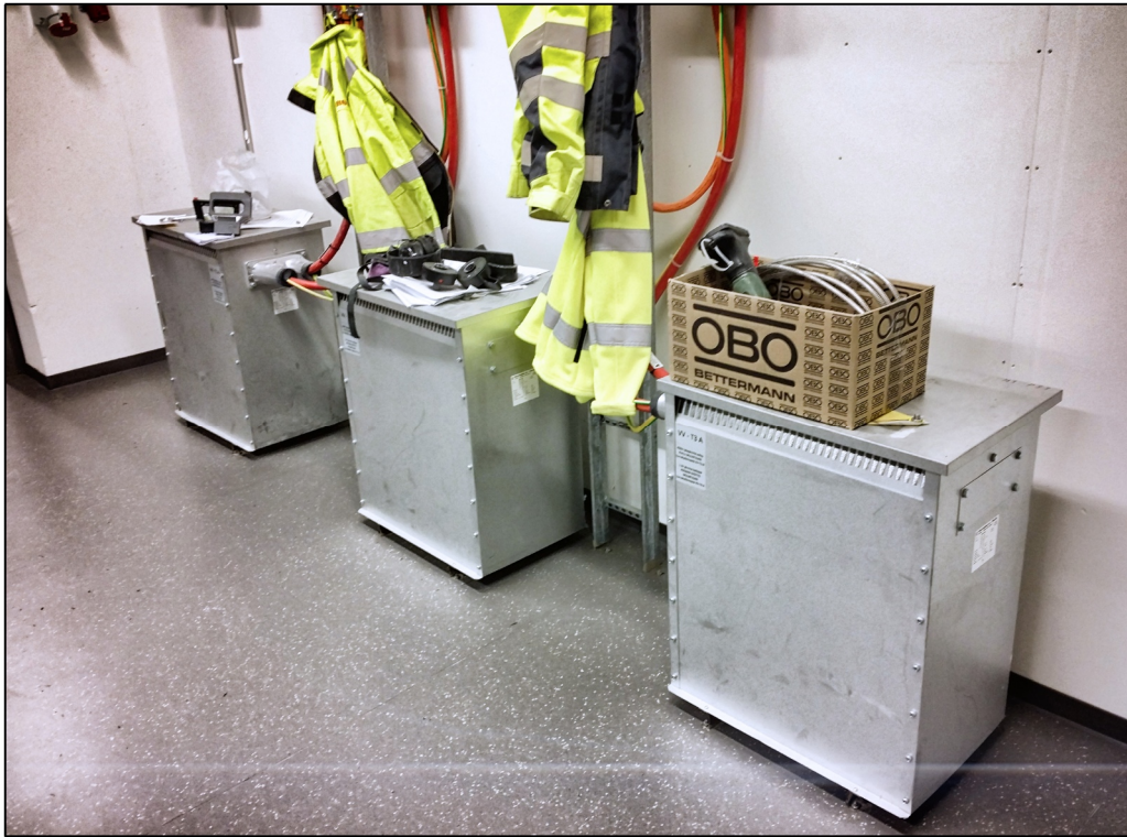
Kuva 5. Kolme kappaletta 0,4/1 kV:n 30 kVA:n muuntajia asennettuna.
