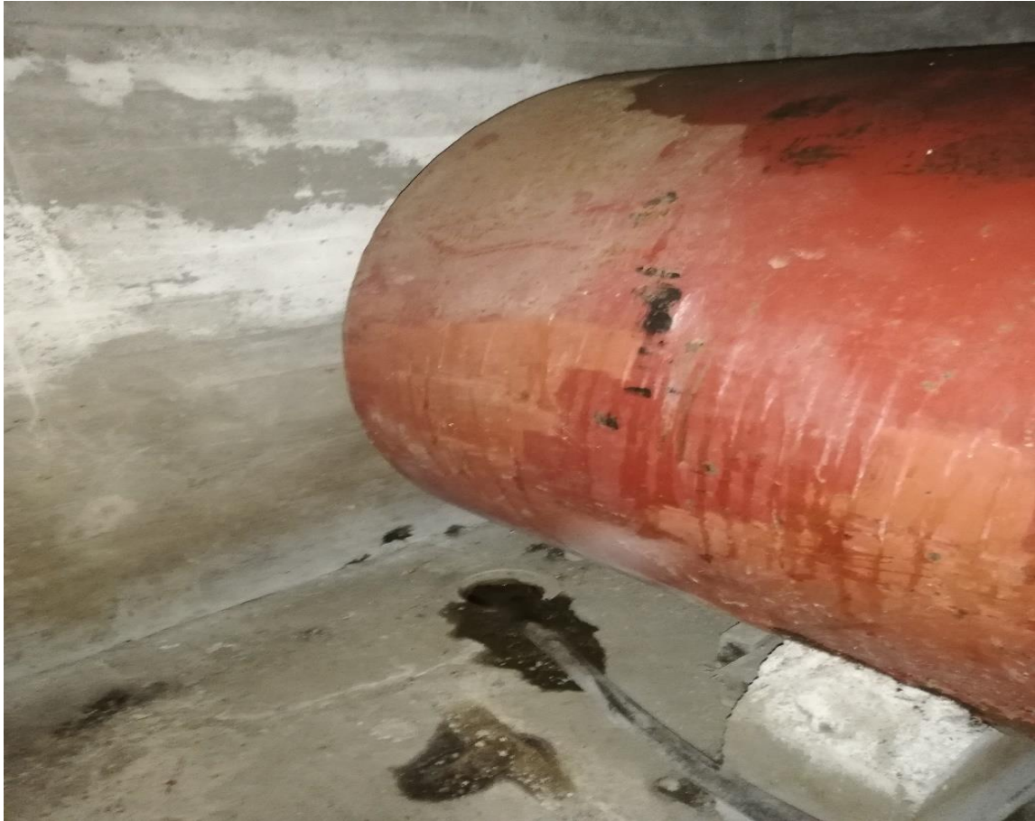
KUVA 3. Rakennuksen alla oleva öljysäiliö
