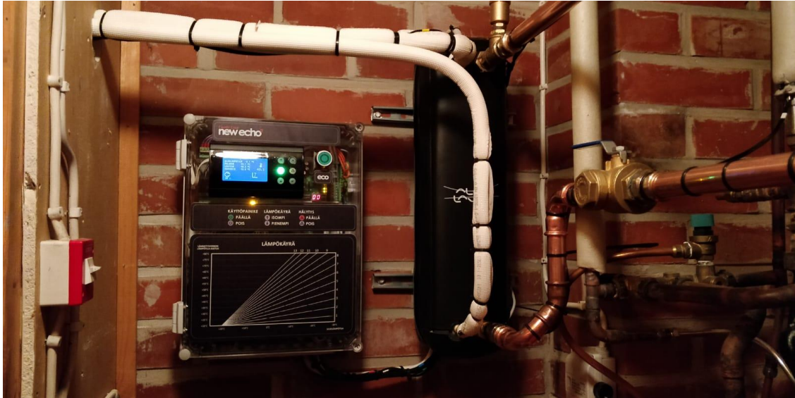
KUVA 12 UVLP:n ohjausyksikkö ja levylämmönvaihdin
