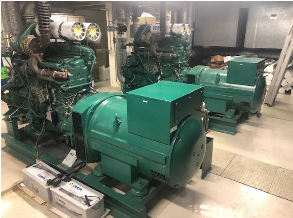
Kuva 4. Lapin keskussairaalan kaksi suurinta dieselgeneraattoria.
