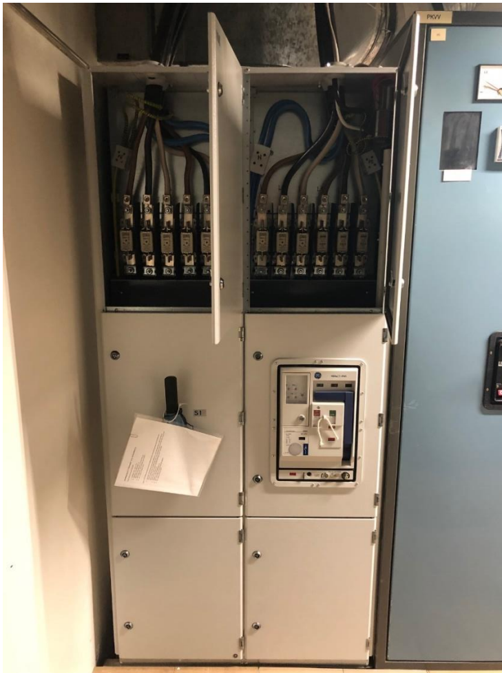
Kuva 7. VVK keskus Lapin keskussairaalassa. Rakennettu varaus varavoimakonttia varten.
