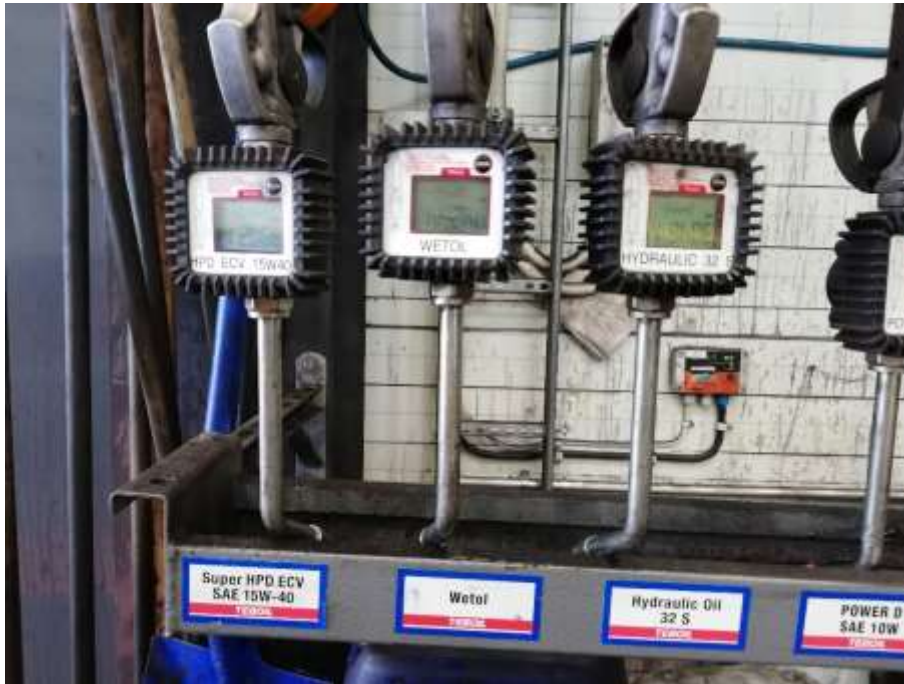
KUVA 11. Öljypistooleihin tehtiin merkinnät helpottamaan niiden tunnistamista
