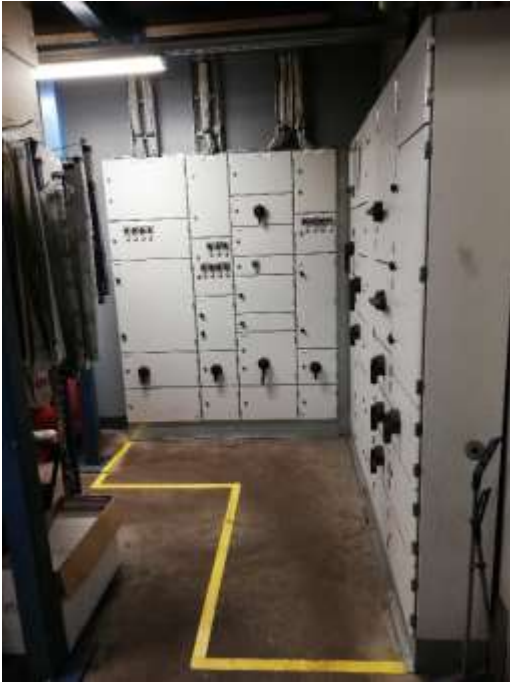
KUVA 14. Sähkökeskuksen edustan lattiamerkintä
