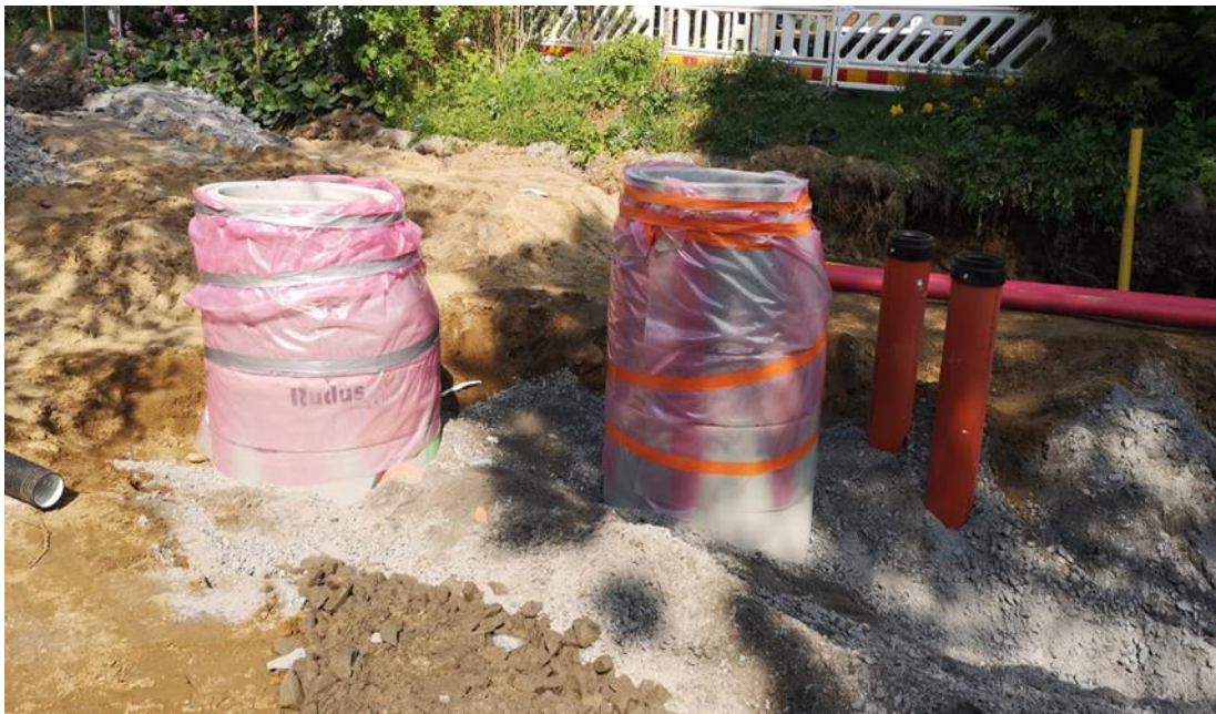
Kuva 5. Sadevesi- ja jätevesikaivo.
